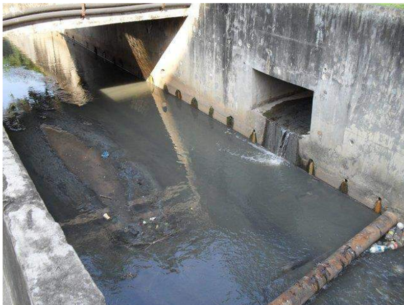
Figura 41 – Seção do Rio Trapicheiros assoreada, próxima à Rua Alzira Brandão. (Fonte: Rio-Águas, 2010)
