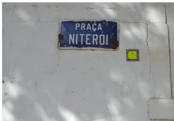
Figura 52 – Monitoramento de recalque (em amarelo) em edifício na Praça Niterói. (Fonte: Autora, foto tirada em 26 de Novembro de 2014)
