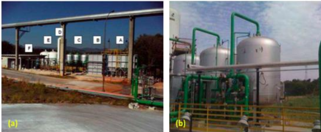
Figura 4: Em a) A) Actiflo, B) Filtro de areia, C) Filtros de CAG, D) e E) Tanque de alimentação para EDR e F) EDR. Em b) Detalhe do filtro de carvão ativado. Fonte: Florido e Santiago (2009), em: MACHADO (2013)
