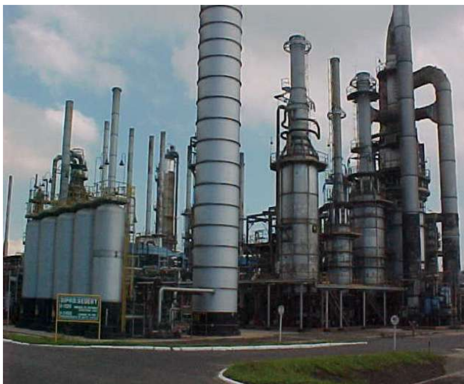
Figura 2.5 - Unidade de Reforma Catalítica da PETROBRAS. Fonte: PETROBRAS (2008c).
