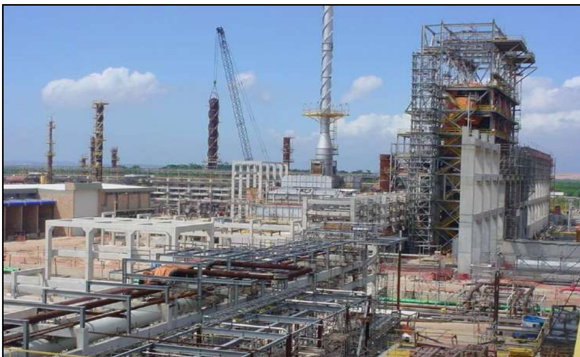
Figura 2.3 - Unidade de Coqueamento Retardado da PETROBRAS.
