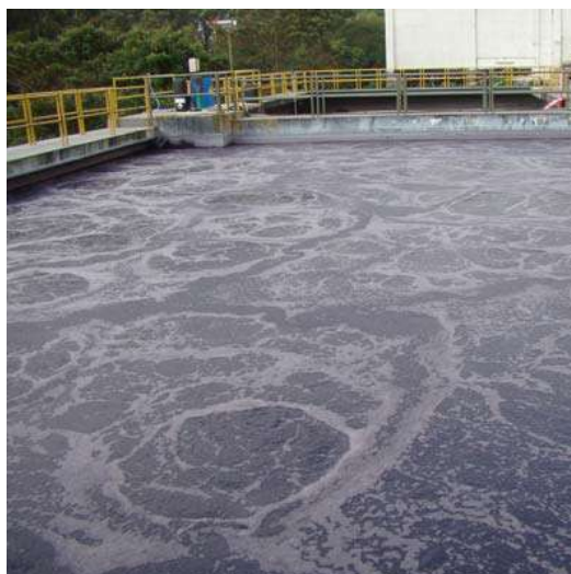
Figura 2.4 – Tanque Biológico vista lateral
