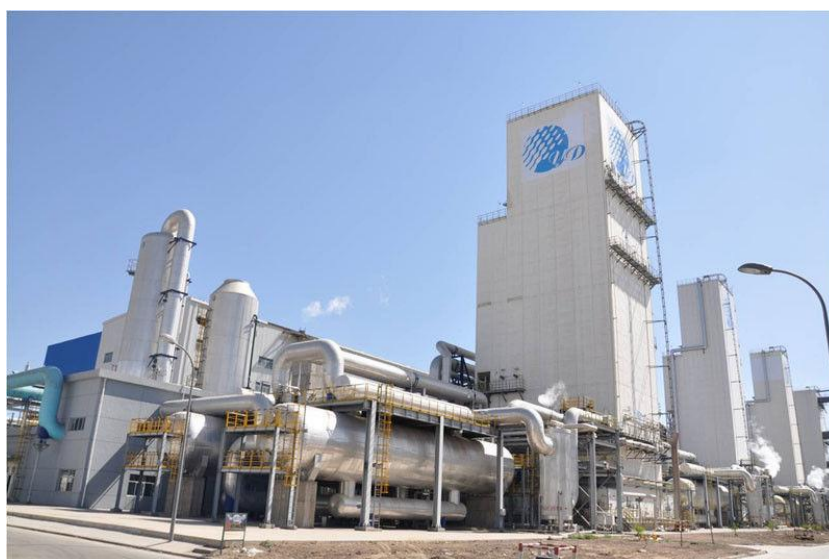
Figura 6 - Planta de destilação criogênica (CHINA NATIONAL AIR SEPARATION ENGINEERING CO., [s.d.]).
