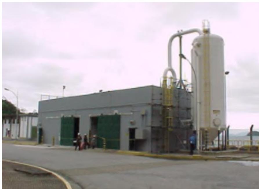
Figura 14 - Foto da instalação de eletrocloração da Usina 1 vista de fora na qual podemos ver o tanque de armazenamento/separação (LEITE, 2021).
