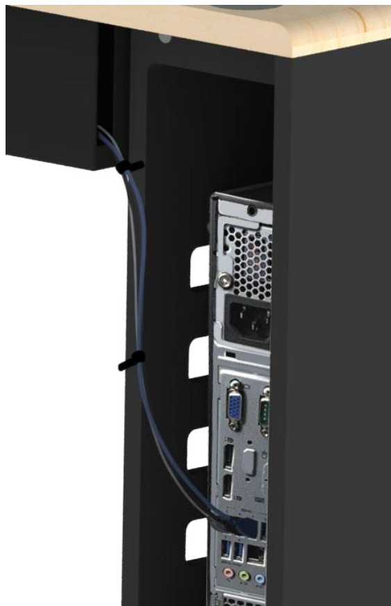
Figura 149 - Cabos Saindo da Caixa de Fios
