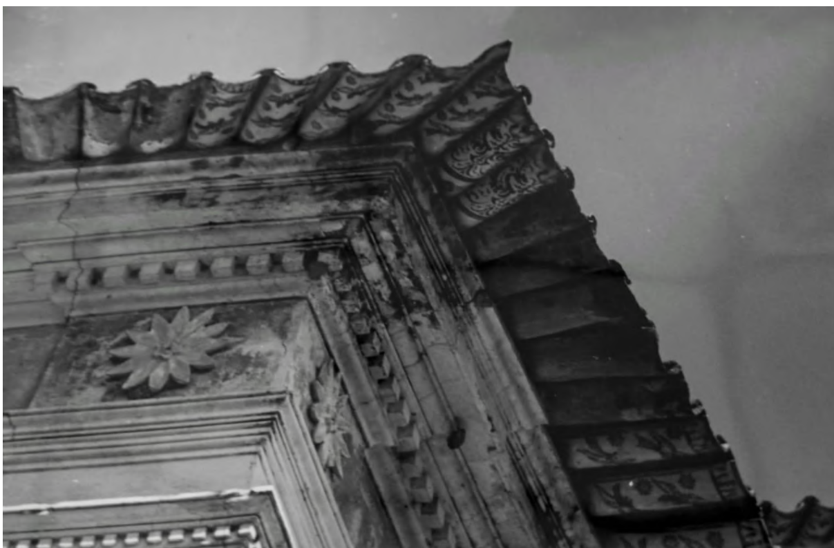
Figura 4 - Detalhe dos estuques que ornamentavam a fachada e dos beirais em louça manufaturados pela fabricada Rato em Cidade do Porto, Portugal. Várias das louças já tendo sido rudemente substituídas por cimento. 16
