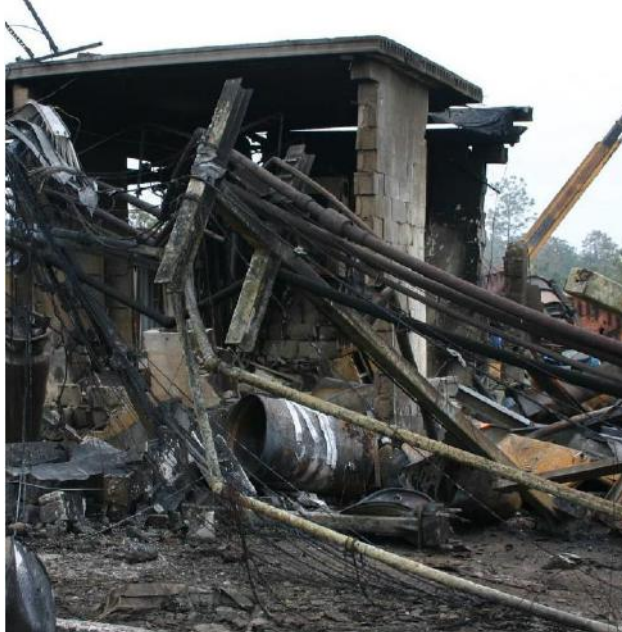
Figura 28: Sala de Controle da T2 Lab. após o acidente.
