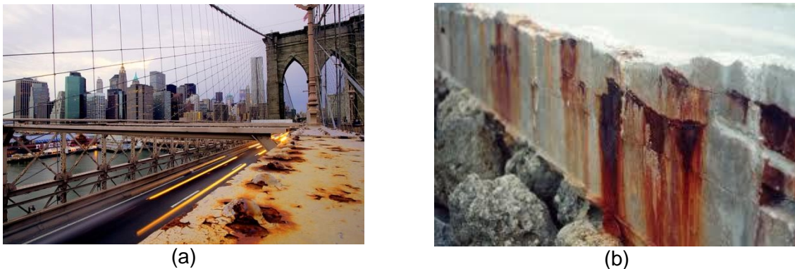
Figura 17: (a) Corrosão localizada em metal. (b) Corrosão em concreto
