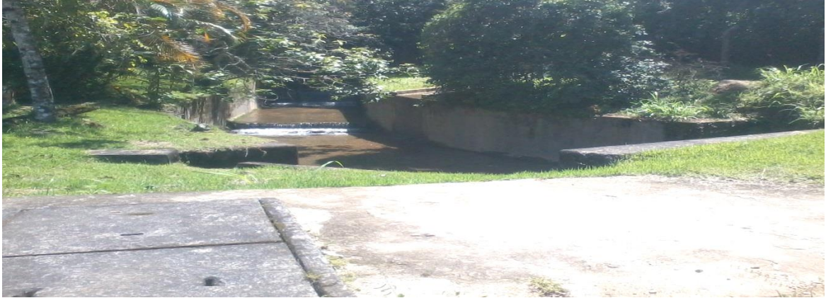
Figura 5- Vista frontal do canal nº 5 da CNAAA
