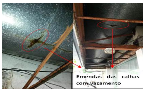
Figura 92: Calha com vazamentos – Fonte: O autor
