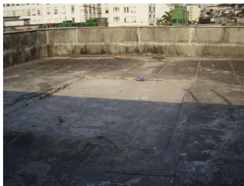
Figura 85: Laje com estado de conservação ruim – Fonte: O autor
