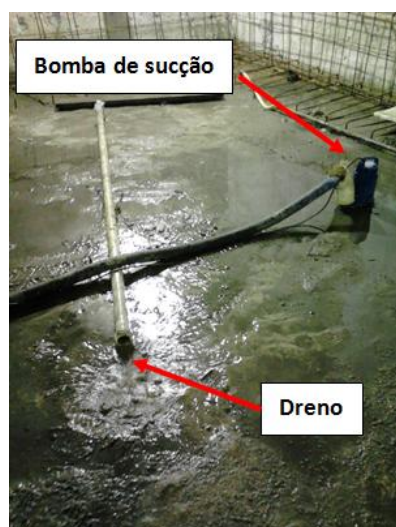
Figura 70: Dreno e bomba de sucção em subsolo – Fonte: O autor
