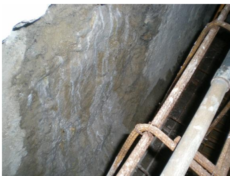
Figura 72: Áreas das vigas com pontos de infiltração – Fonte: O autor
