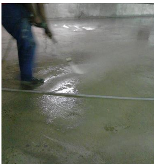
Figura 49: Aplicação de jato de água para limpeza da superfície – Fonte: O autor
