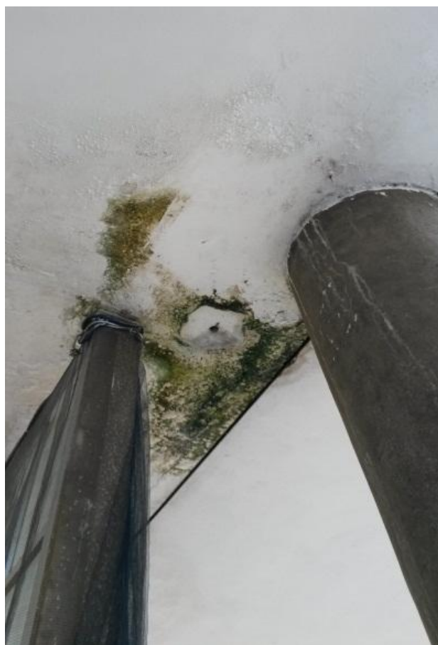
Figura 2: Infiltração em laje de concreto - Fonte: O autor
