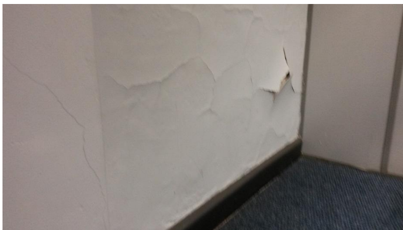
Figura 47: Parede com patologia decorrente de umidade ascendente – Fonte: O autor
