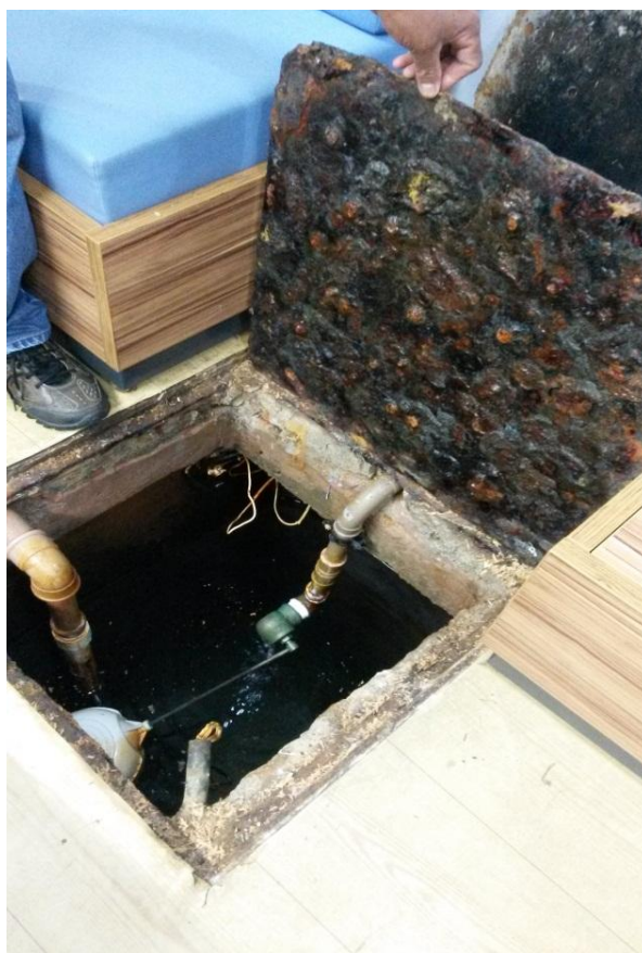
Figura 67: Tampa de cisterna corroída – Fonte: O autor
