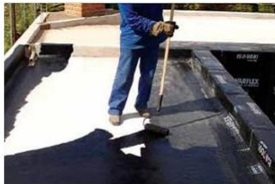
Figura 80: Imprimação com rolo de lã de carneiro - Fonte: métodos executivos de impermeabilização – Freire, 2007
