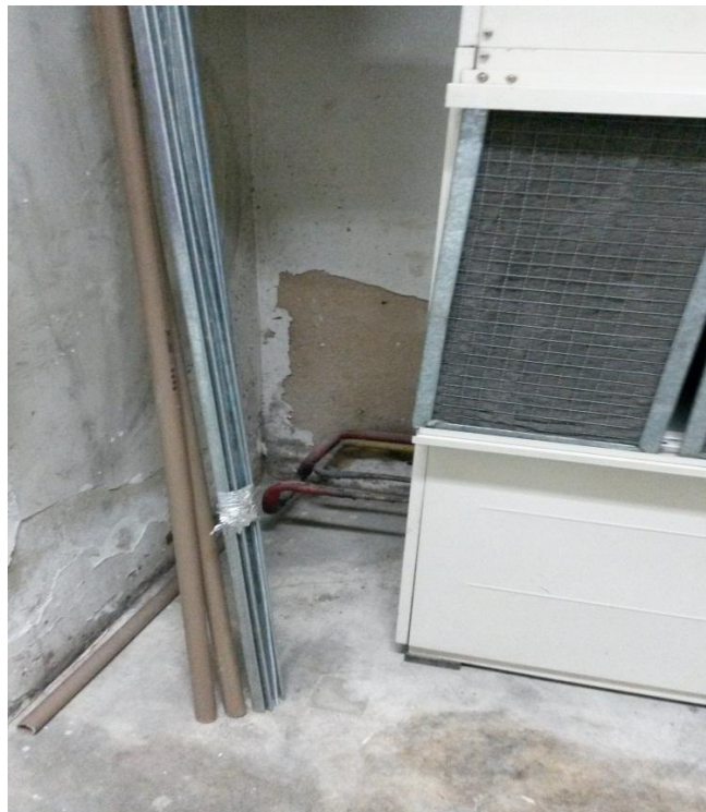
Figura 5: Umidade de condensação em casa de máquinas Fonte: O autor
