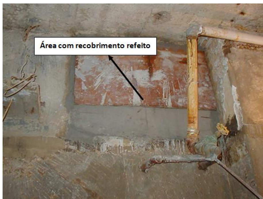
Figura 65: Área de reservatório com recobrimento refeito – Fonte: Cetimper
