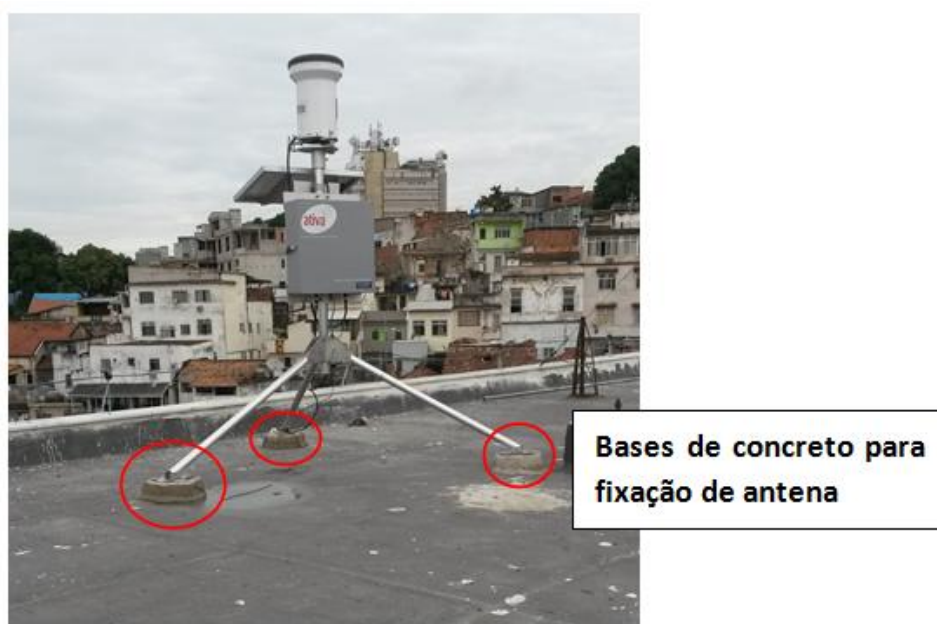
Figura 90: Bases de concreto para fixação de antena em terraço – Fonte: O autor
