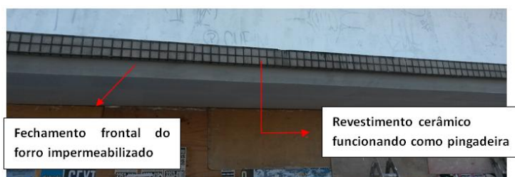
Figura 98: Marquise e forro de gesso impermeabilizados – Fonte: O autor
