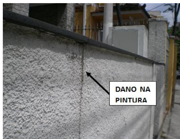
Figura 38: Muro com manchas, devido falta de pingadeira – Fonte: O autor
