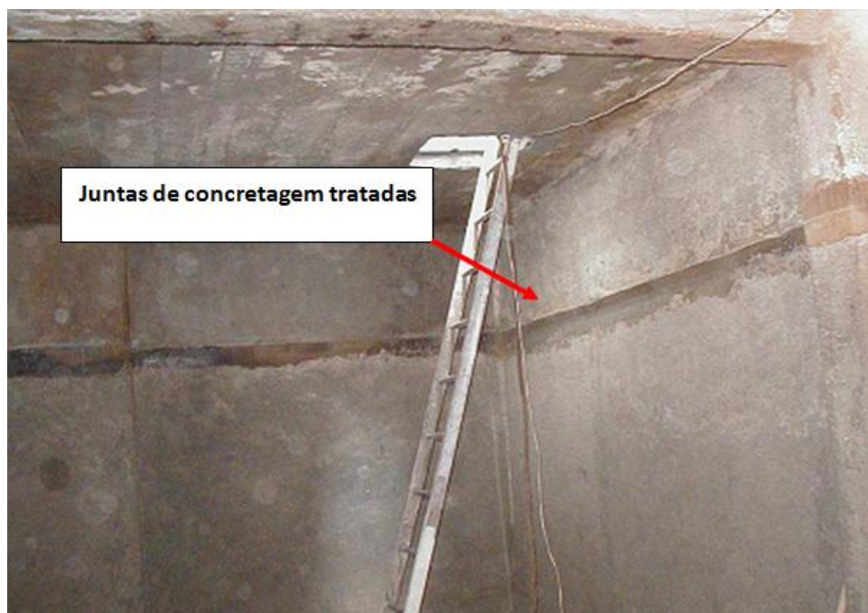
Figura 66: Juntas de concretagem tratadas com argamassa tipo Grout – Fonte: Cetimper
