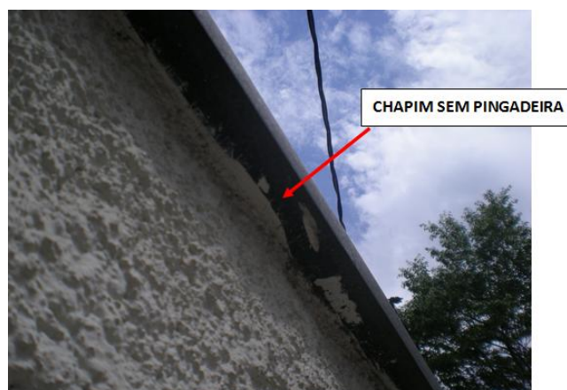
Figura 39: Chapim sem pingadeira em muro – Fonte: O autor
