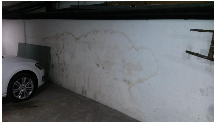
Figura 8: Garagem com efeitos umidade por pressão negativa – Fonte: O autor
