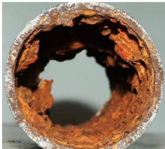
Figura 5 Exemplo de corrosão em uma tubulação
