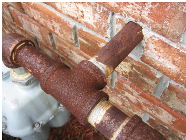
Figura 8 Exemplo de corrosão uniforme
