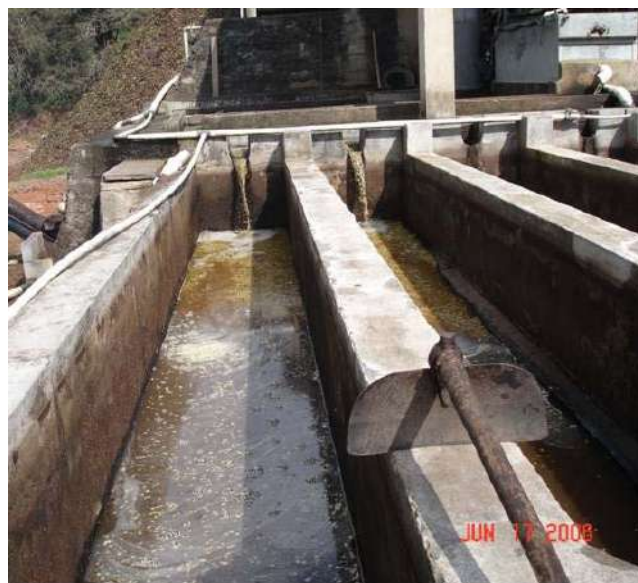
Figura 2.5: Tanque de fermentação
