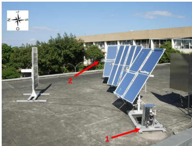
Figura 4.4: Sistema fotovoltaico concentrador. 1) Motor de azimute; 2) Motor de elevação.
