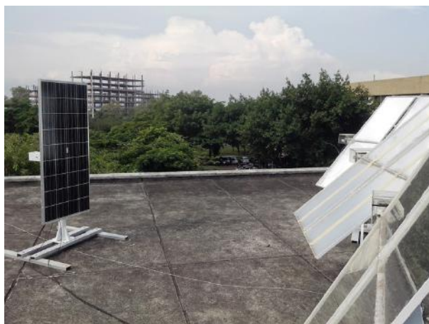
Figura 2.10: Sistema concentrador instalado utilizado neste trabalho. Fonte: Projeto Fazenda Solar – LIF-COPPE/UFRJ.
