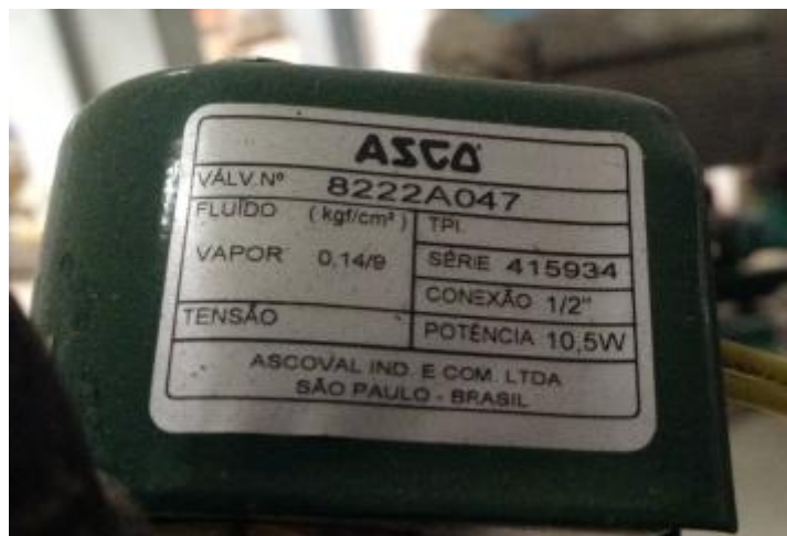
Figura 15 - Imagem da válvula solenóide instalada
