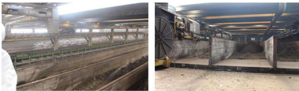
Figura 29 - Seção de compostagem do digestato em uma planta de DA de Bassano del Grappa (VI), Italia
