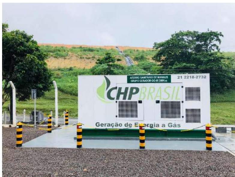
Figura 27 - Imagem de um motor de cogeração do tipo CHP usado para gerar energia a partir do biogás coletado em aterro (CHP Brasil)
