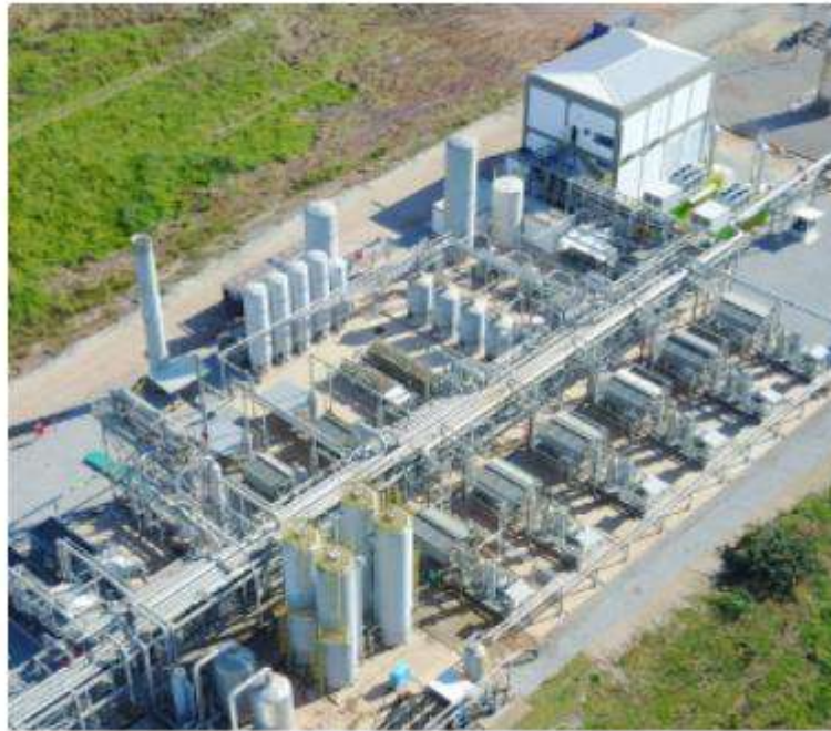
Figura 25 - Visão da planta de produção de biometano a partir do biogás gerado no aterro de Seropédica, RJ (Urca Energia)
