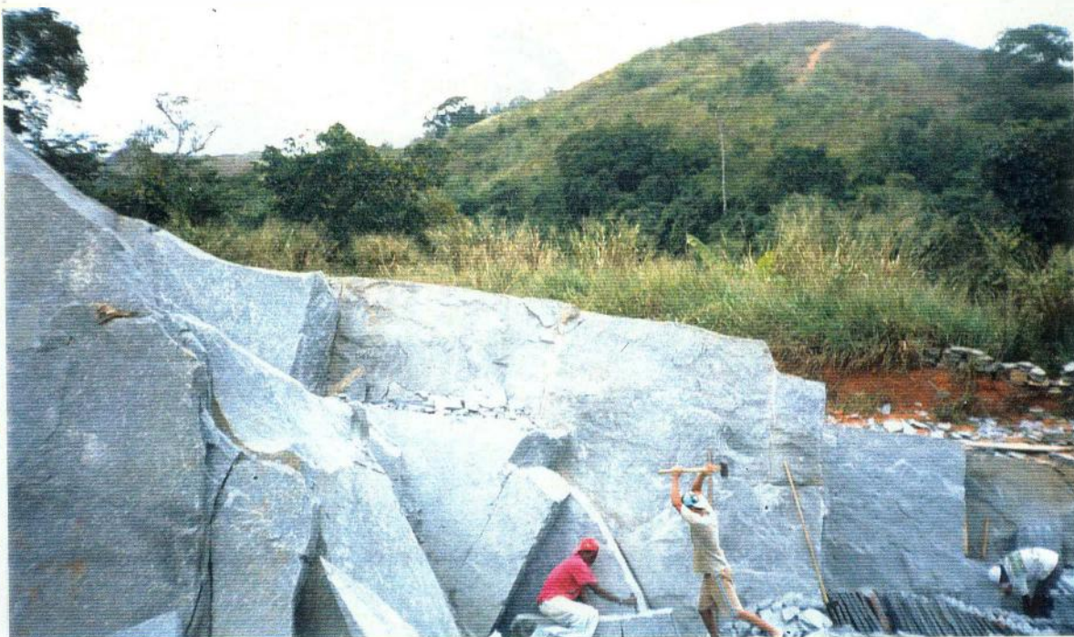
Fotografia 04: Nota-se os operários quebrando os blocos em frente a uma lavra na pedreira do Sr. Nacif.
