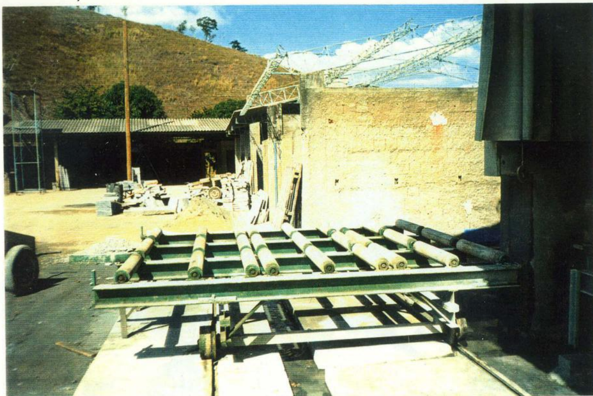
Fotografia 22: Observa-se uma estrutura verde sobre trilhos. Trata-se do carro de alimentação, que tem a função de transportar o bloco do caminhão até a Serra-Ponte para ser cortado.
