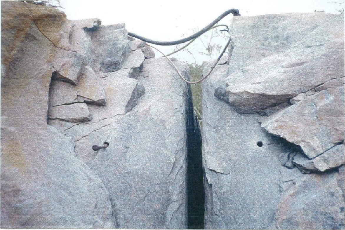
Fotografia 02: Observa-se a rocha após a utilização do flame-jet , com uma separação de aproximadamente 10 cm. Frente de lavra da Pedreira do Sr. Nacif.
