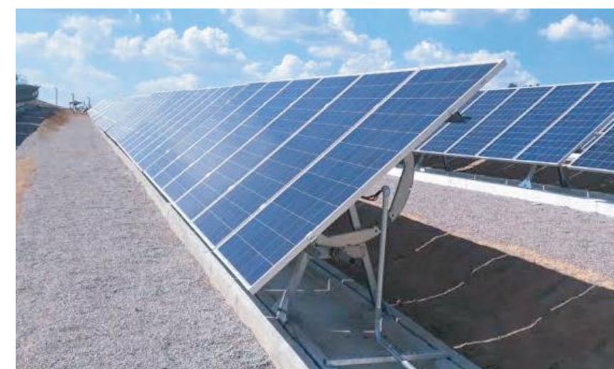
il. 19– Placas fotovoltaicas com tracker de um eixo Imagem obtida através de mensagens
