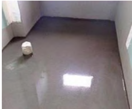
Figura 4.17 – Teste de estanqueidade.
