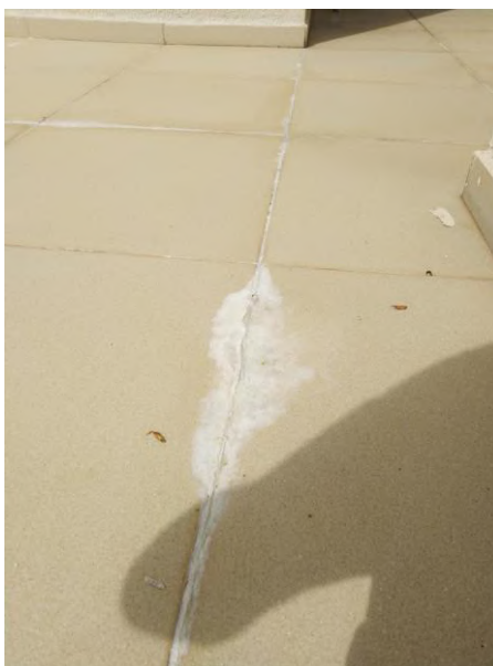
Figura 3.13 – Eflorescência em piso cerâmico.
