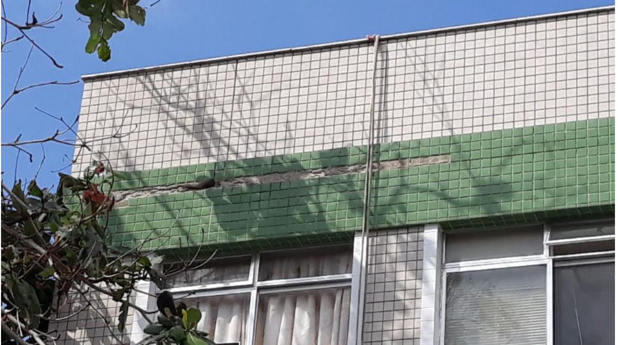
Figura 20 - Fissuras e desagregação do emboço (Fonte: Acervo pessoal)
