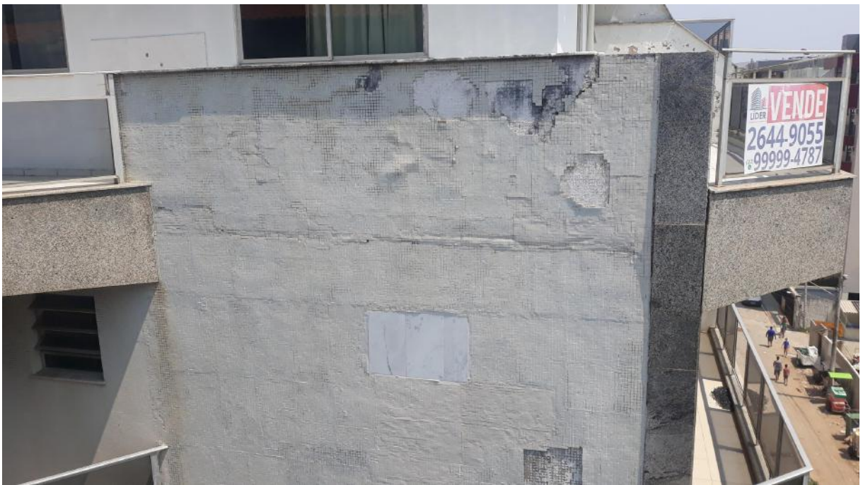
Figura 34 - Estufamento e queda de revestimentos (Fonte: Acervo pessoal)
