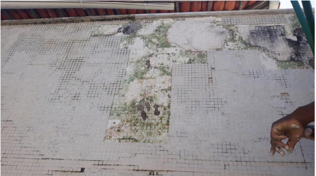
Figura 36 - Emboço deteriorado (Fonte: Acervo pessoal)
