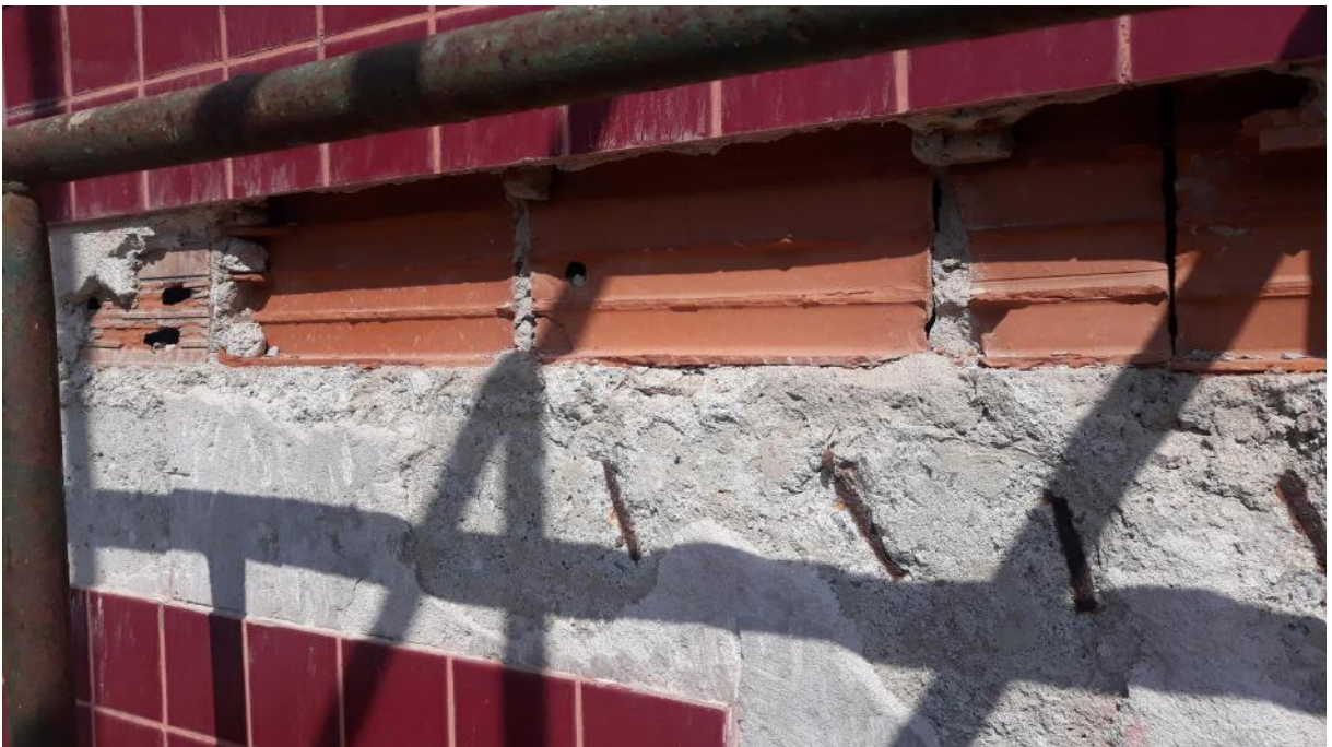
Figura 41 - Encontro da estrutura com alvenaria (Fonte: Acervo pessoal)
