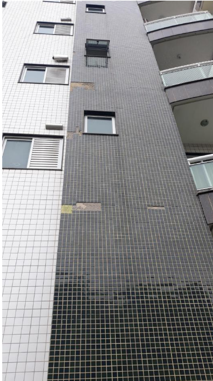
Figura 26 - Destacamentos nas divisões dos pavimentos (Fonte: Acervo pessoal)
