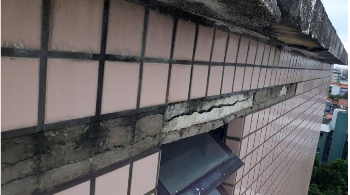
Figura 16 - Fissuras no emboço (Fonte: Acervo pessoal)
