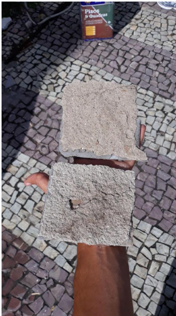
Figura 9 - Desagregação do próprio emboço (Fonte: Acervo pessoal)
