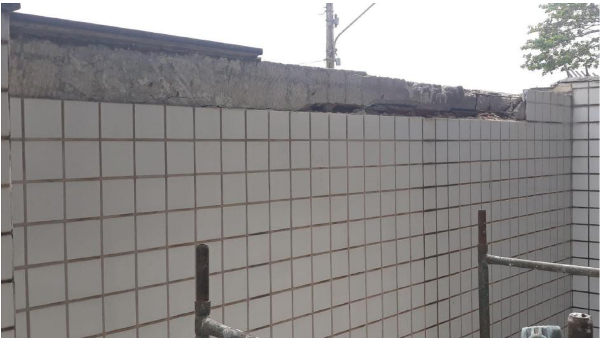
Figura 62 - Corrosão de armaduras e ponto de encunhamento (Fonte: Acervo pessoal)
