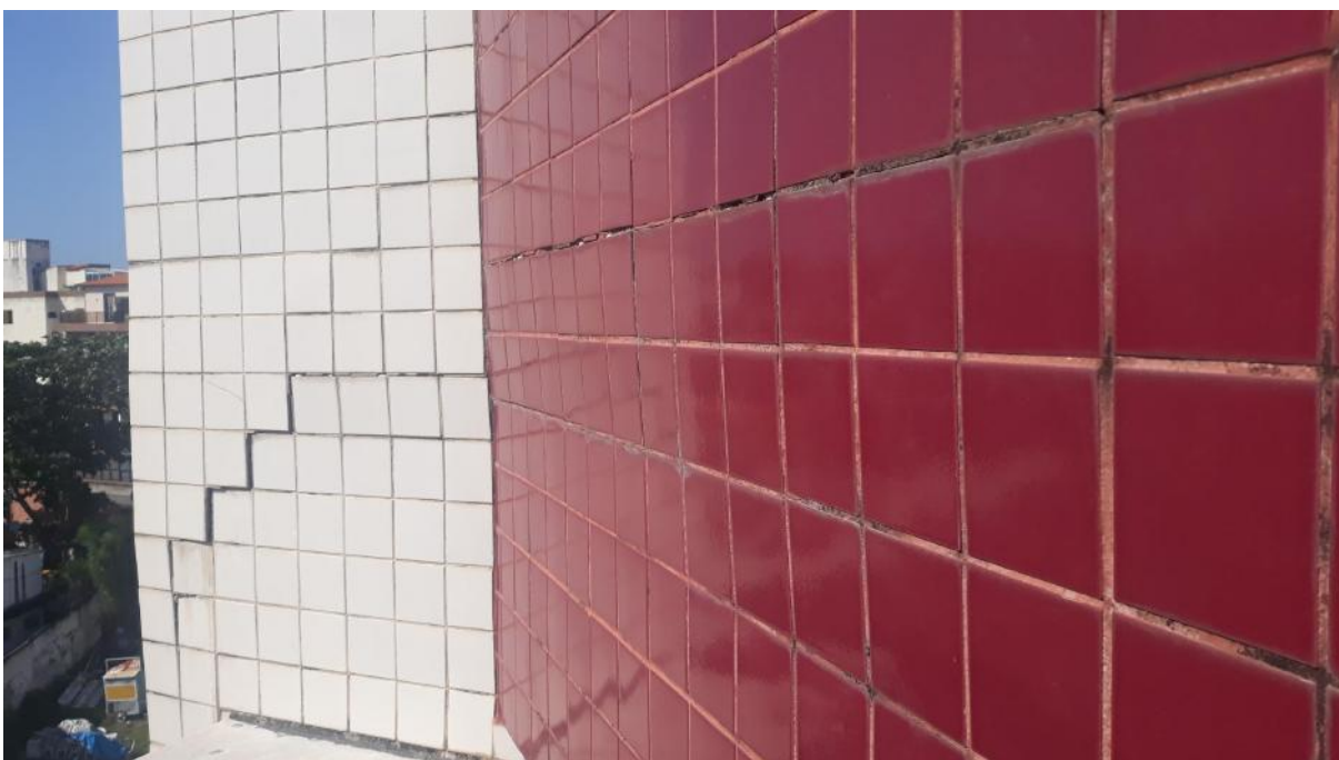
Figura 39 - Fissuração e estufamento do revestimento (Fonte: Acervo pessoal)
