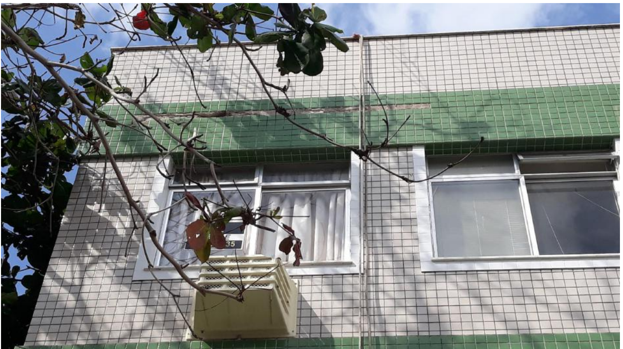
Figura 21 - Fissuras e desagregação do emboço (Fonte: Acervo pessoal)
