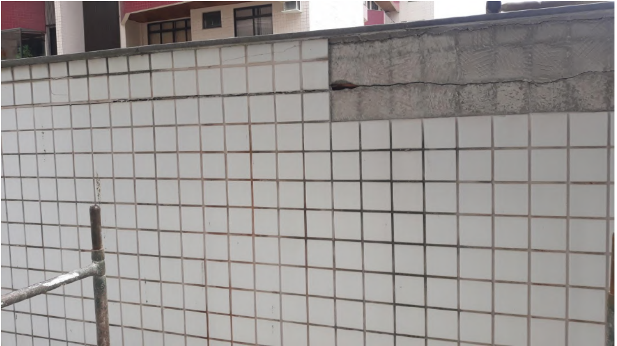
Figura 61 - Fissuração do emboço (Fonte: Acervo pessoal)
