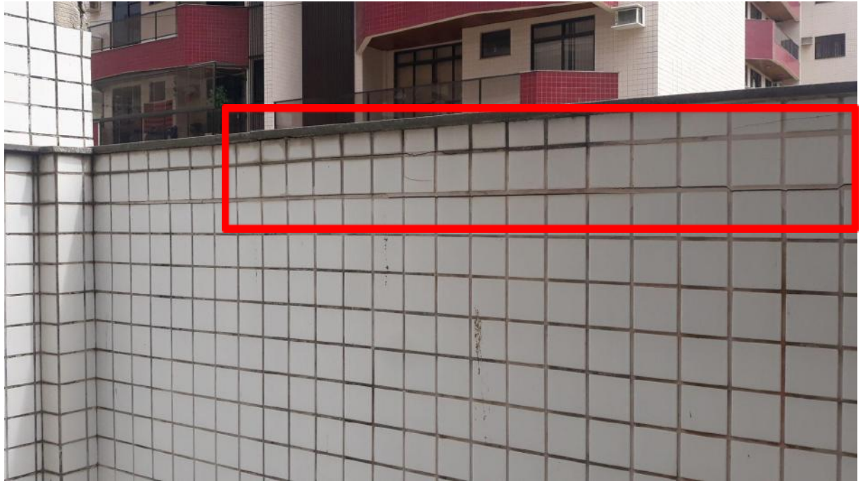
Figura 58 - Fissuração do revestimento (Fonte: Acervo pessoal)
