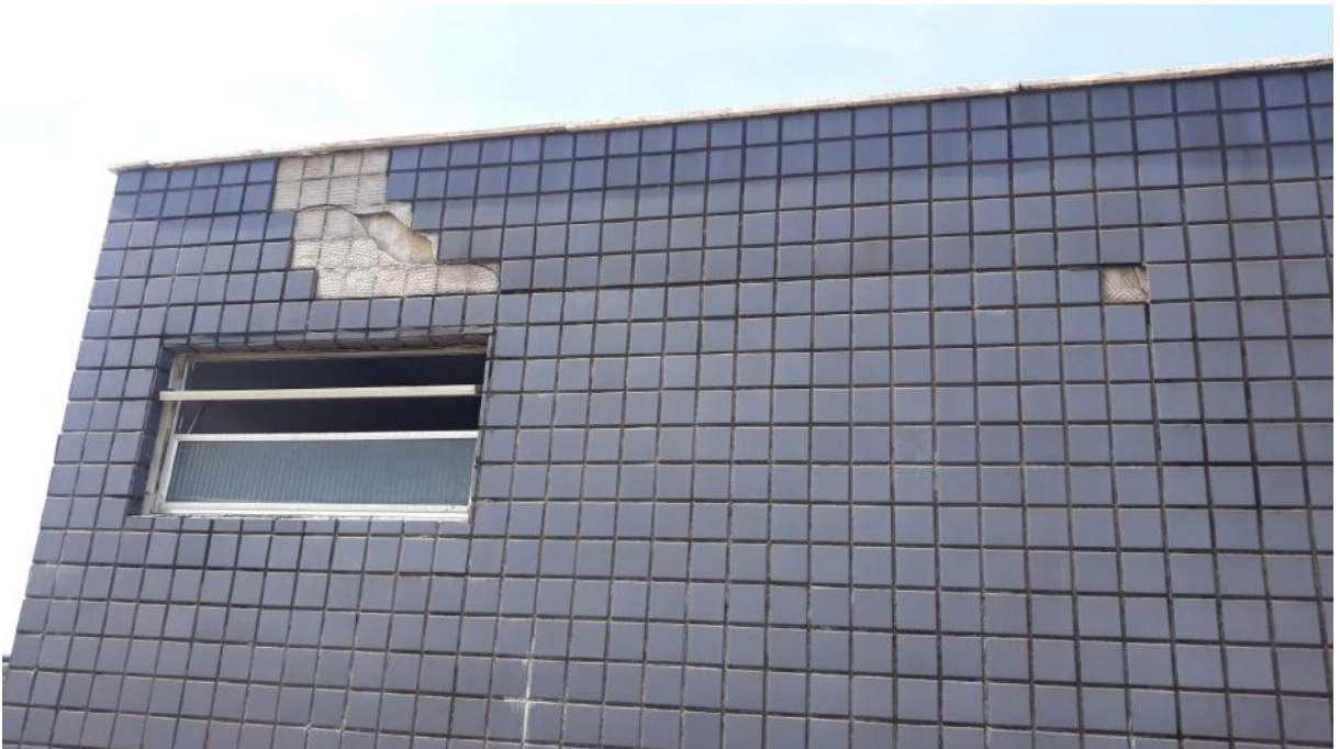
Figura 17 - Fissuras e desagregação do emboço (Fonte: Acervo pessoal)
