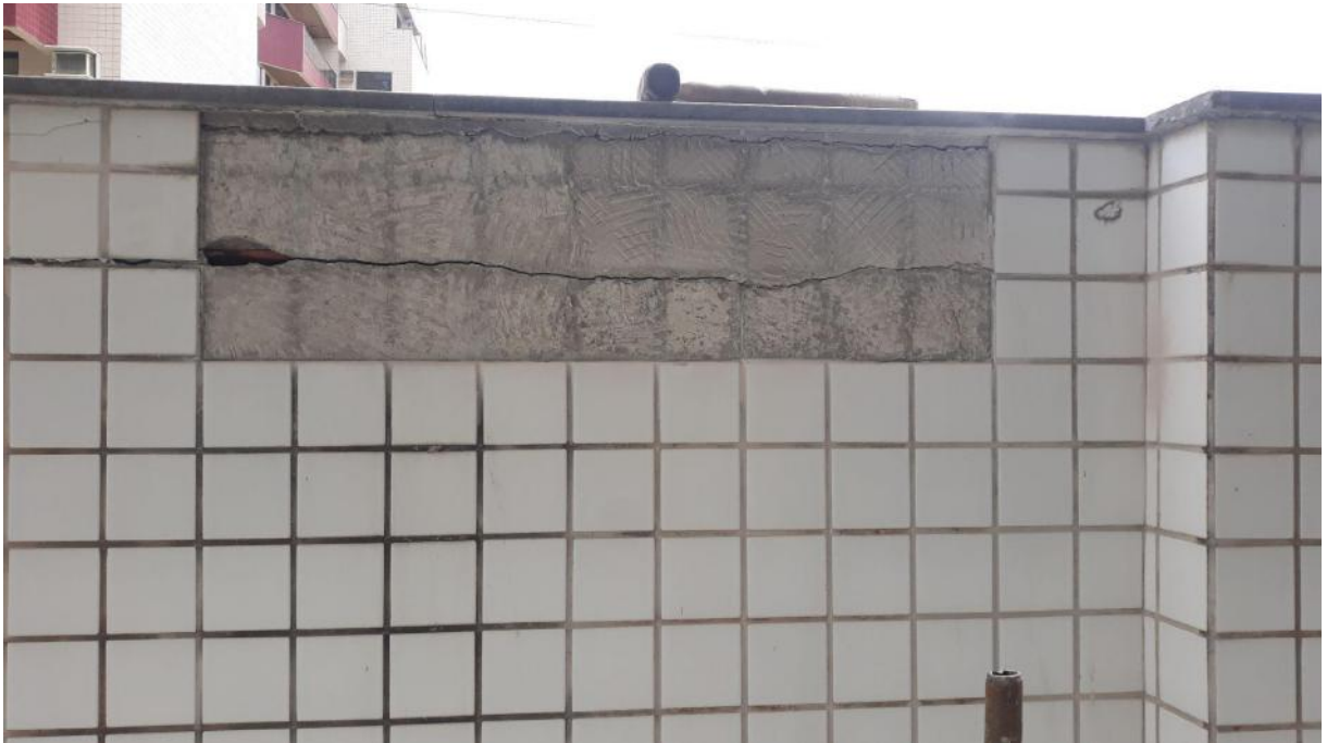
Figura 60 - Fissuração do emboço (Fonte: Acervo pessoal)
