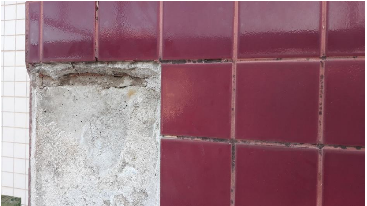
Figura 40 - Fissuração do emboço (Fonte: Acervo pessoal)
