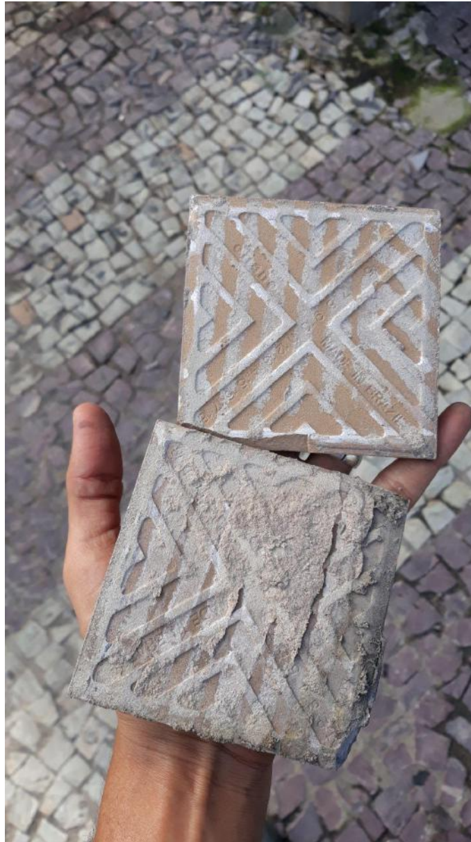
Figura 8 - Perda de aderência entre cerâmica e argamassa colante (Fonte: Acervo pessoal)
