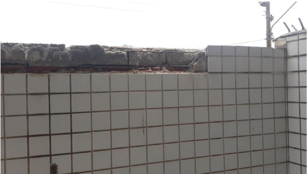
Figura 63 - Corrosão de armaduras e ponto de encunhamento (Fonte: Acervo pessoal)
