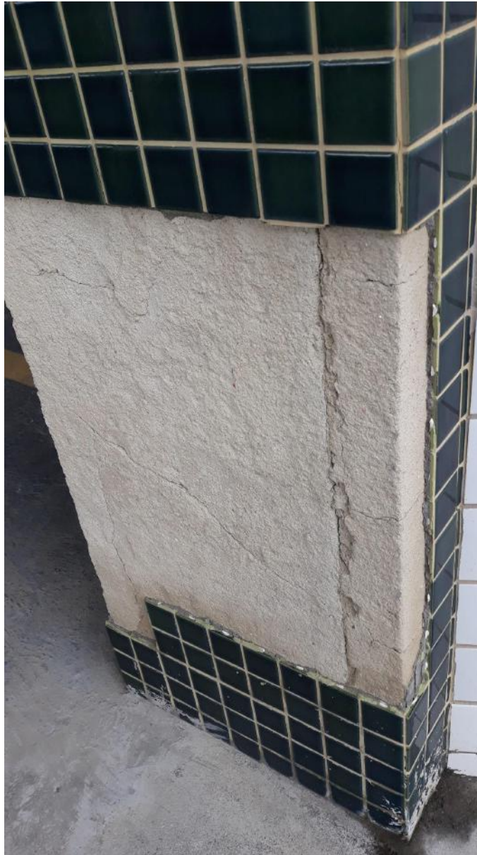
Figura 31 - Emboço deteriorado (Fonte: Acervo pessoal)
