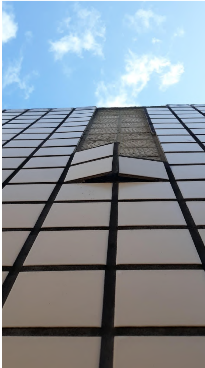
Figura 50 - Descolamento na área de ventilação (Fonte: Acervo pessoal)
