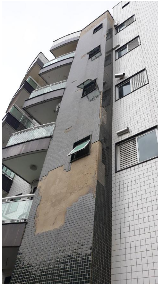
Figura 30 - Emboço deteriorado (Fonte: Acervo pessoal)
