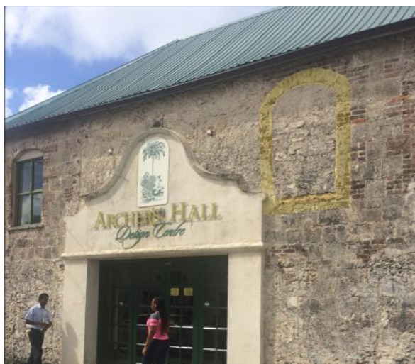
Figura 7.107. Janela cobertado inadequadamente. Fonte: Autora, 2019.
