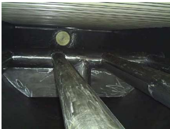
Figura 2-18: Foto dos quatro segmentos distribuidores de um tratador Dual Polarity da Bacia de Campos.
