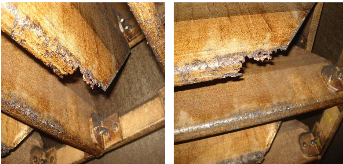
Figura 2-20: Placas de eletrodos danificadas por arco elétrico numa plataforma na Bacia de Campos.
