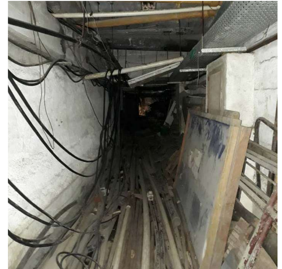
Subsolo técnico do edifício. Shaft de instalações que se encontra atrás da caixa dos elevadores(lateral esquerda) Fonte: Fotografia autoral.
