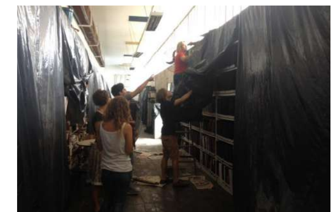
Inundação provocada por infiltrações na cobertura da Biblioteca Lúcio Costa. Foto: Jéssica Moraes, 22 de nov. de 2016.
