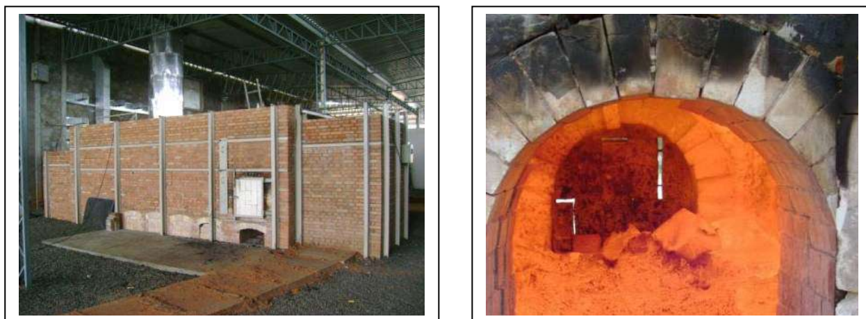
Figura 5.21 - Vista lateral (a) e do interior (b) do queimador de fumaça
