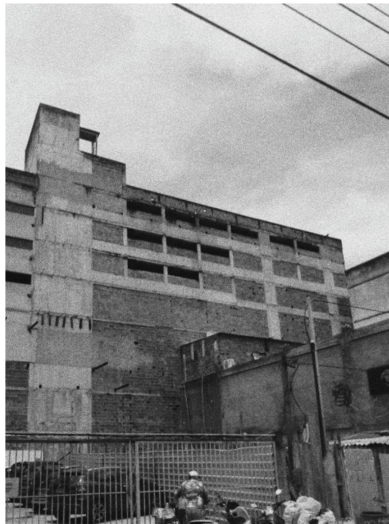
Figura 3 Circulação vertical e elementos inacabados destacados na edificação. Foto do autor (2021).
