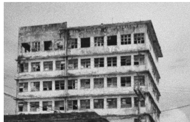
Figura 10 Edifício abandonado no Cais de Santa Rita, Recife (PE). Foto: Marcelo Soares.
