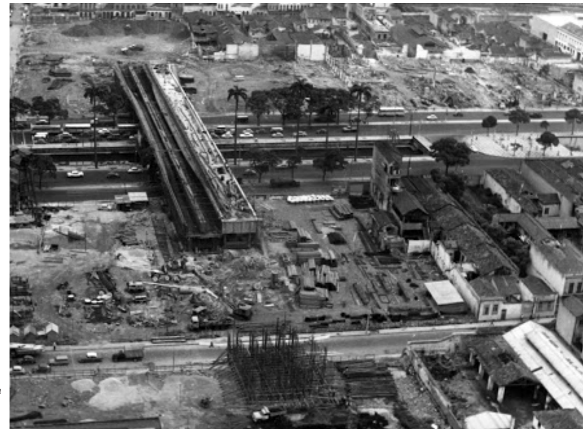
FIG.24 autor desconhecido, Construção do Viaduto S. Sebastião, na altura da Praça Onze (ca. 1975)
