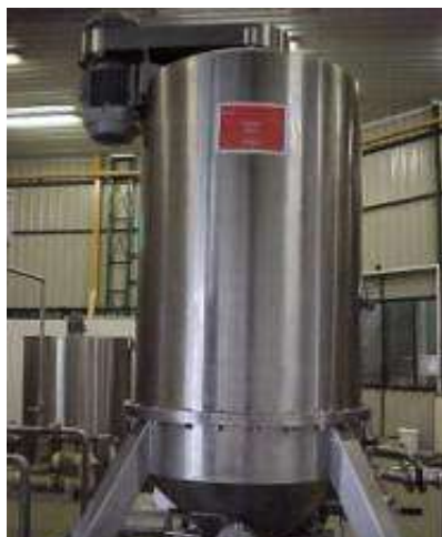
Figura 7 - Deposito de armazenamento
