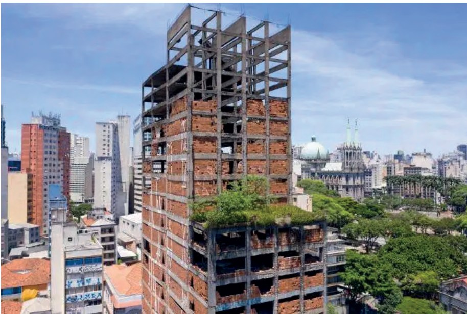
Figura 1: Imagem do edifício em desuso. Fonte: Veja SP.
