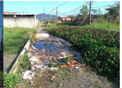
2 Valão totalmente ocupado por vegetação e rua comprometida Fonte: Acervo próprio (2021)
