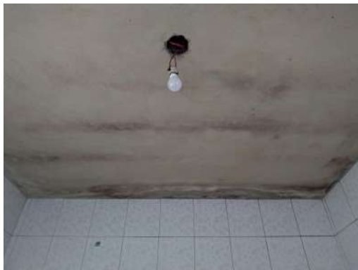
Imagem 100: Problemas encontrados na construção Fonte: Acervo próprio (2021)
