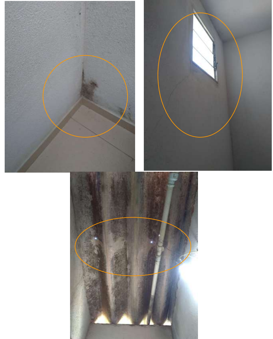
Imagens 94, 95 e 96: Problemas encontrados na construção Fonte: Acervo próprio (2021)
