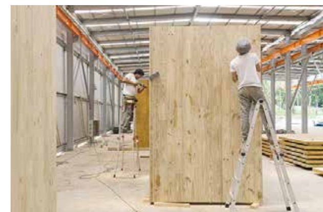
processo de montagem em fábrica dos módulos de CLT dos MINIMODs | fotografias do mapa
