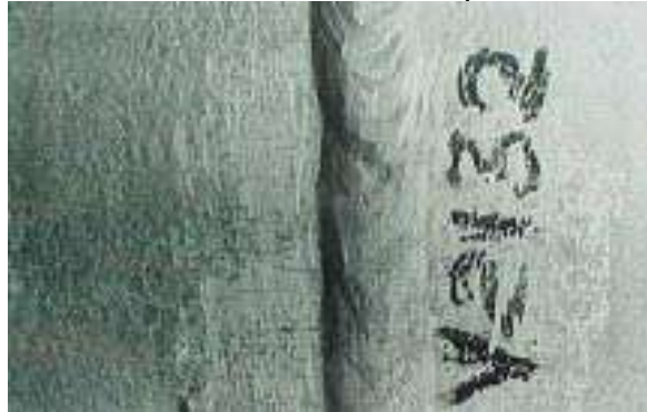
Figura II-XVII Corrosão sob tensão pelo H 2 S em aço carbono
