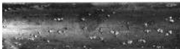
Figura II-XIV Corrosão por pite em tubo de aço inoxidável AISI 304 (FERREIRA et al, 2002).
