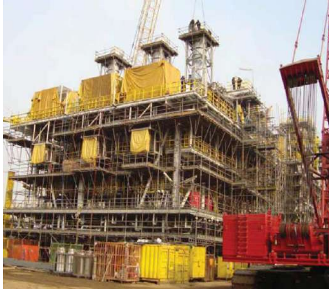
Figura 9 - Módulo de compressão de gás
