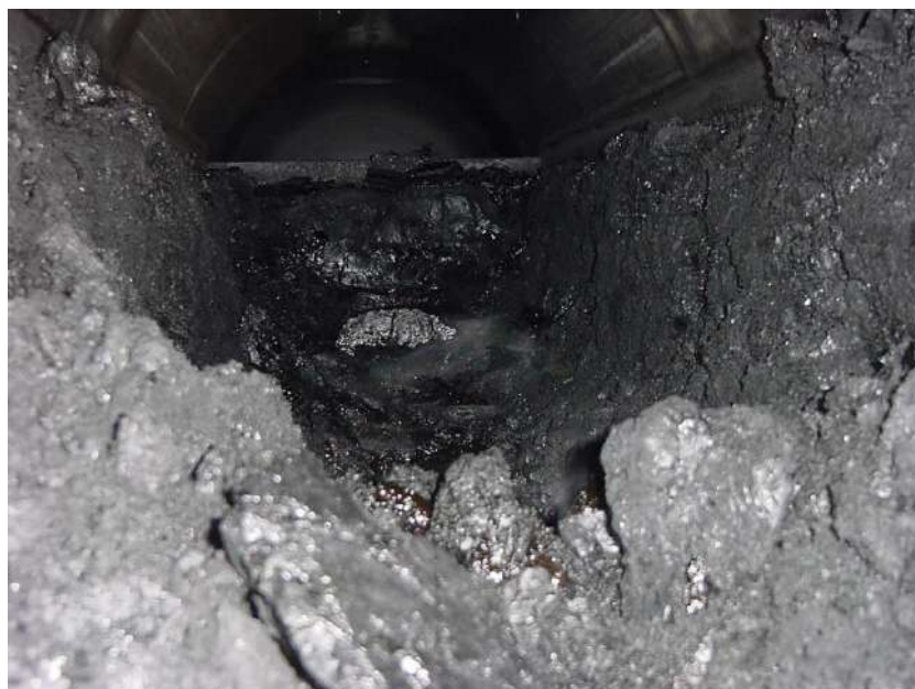
Figura I.2 Precipitado de asfaleno depositado em uma tubulação (YEN,2009).
