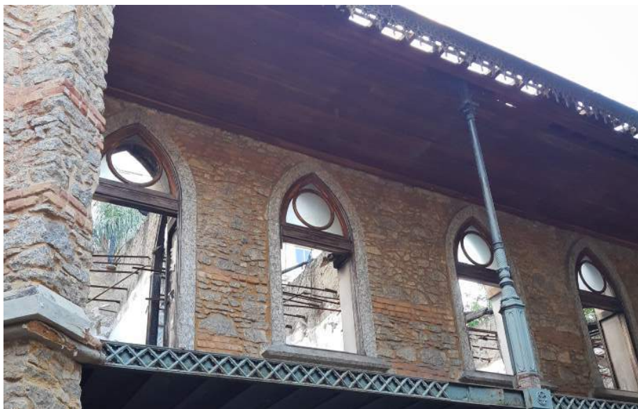
Imagem 9: Vista de uma lateral do casarão, onde é possível ver parte dos danos internos e a falta de guarda corpo. Fonte: Acervo Pessoal
