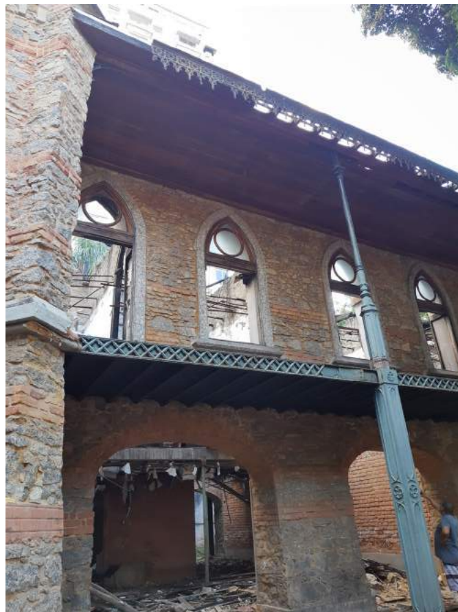
Vista 03 - Varanda superior com resquícios do lambrequim em ferro fundido, forro em madeira deteriorado, e estrutura em ferro oxidada; Vãos superiores com vidro das bandeiras, gradis e folhas de abrir faltantes.
