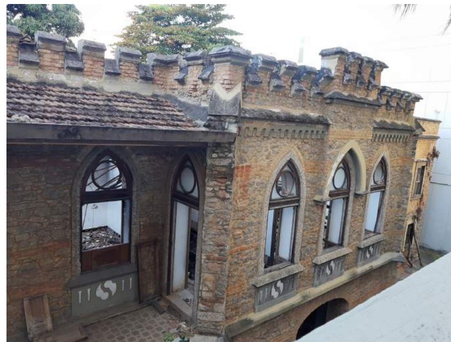
Vista 02 superior - Esquadrias com gradis, folhas de abrir e vidros das bandeiras faltantes. Ausência de ornatos em trevo acima do vão central a direita; Manchas negras na canaleta de água pluvial, ameias e cimalhas intermediária e superior.
