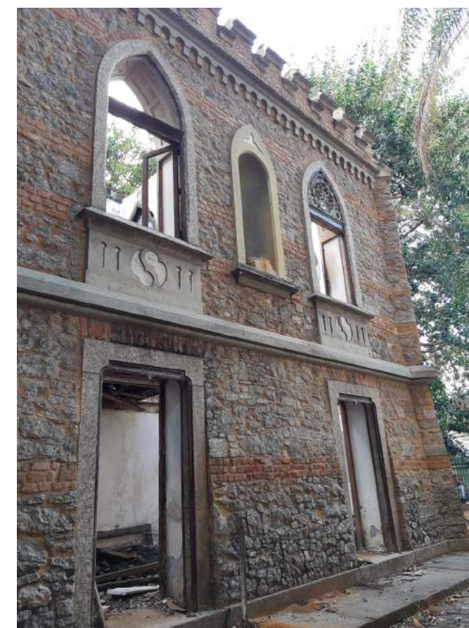
Vista 05 - Vãos inferiores com esquadrias faltantes, vão superior esquerdo somente com suporte da esquadria e vão direito com vidro da bandeira faltante.
