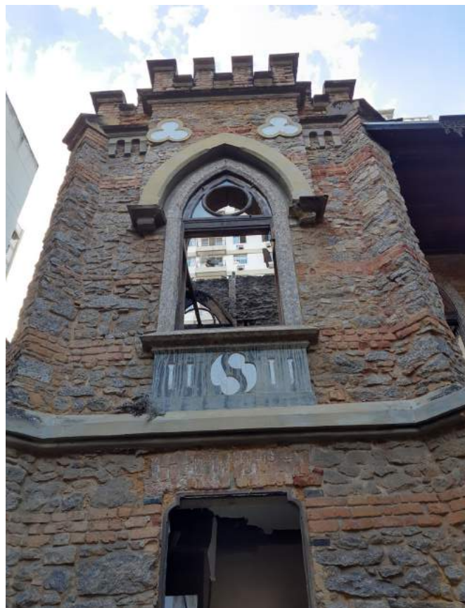
Vista 02 - Vão superior com vidro na bandeira, gradil e folhas de abrir faltantes. contendo friso com vegetação e manchas negras.
