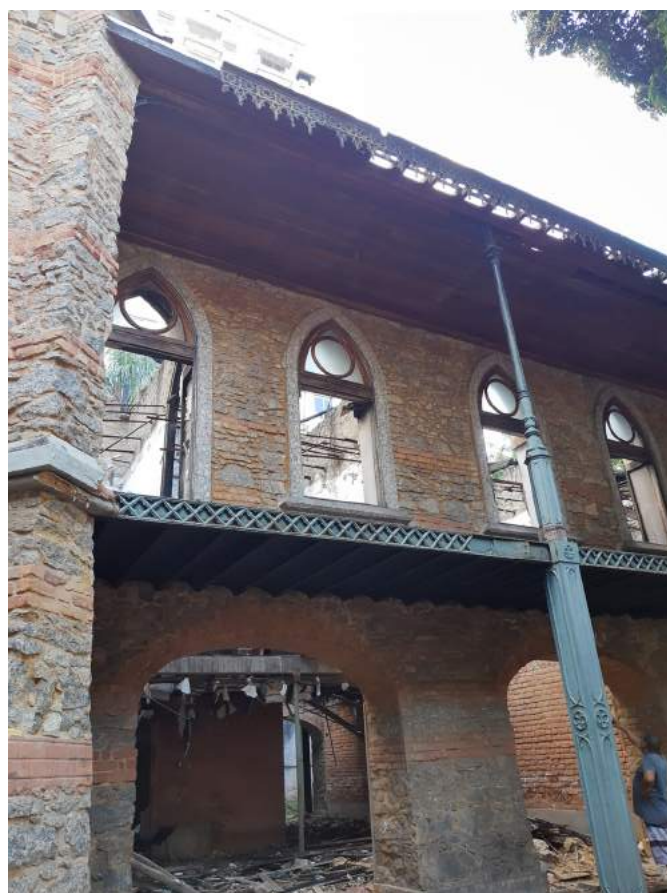
Vista 03 - Varanda superior com resquícios do lambrequim em ferro fundido, forro em madeira deteriorado, e estrutura em ferro oxidada; Vãos superiores com vidro das bandeiras, gradis e folhas de abrir faltantes.
