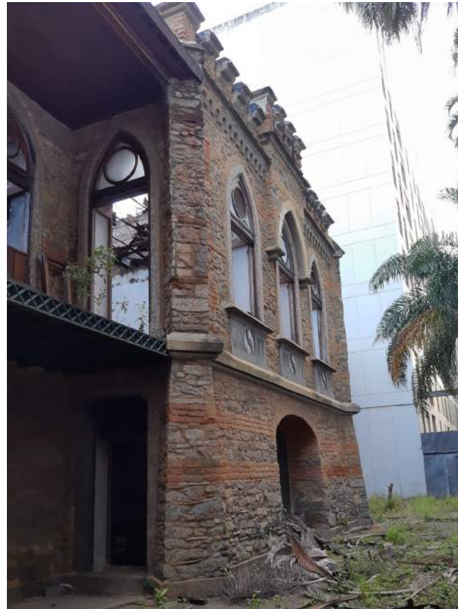
Vista 02 inferior - Vegetação em sua base e manchas negras na cimalha intermediária. Pode-se observar a ausência de forro e cobertura no pavimento superior.
