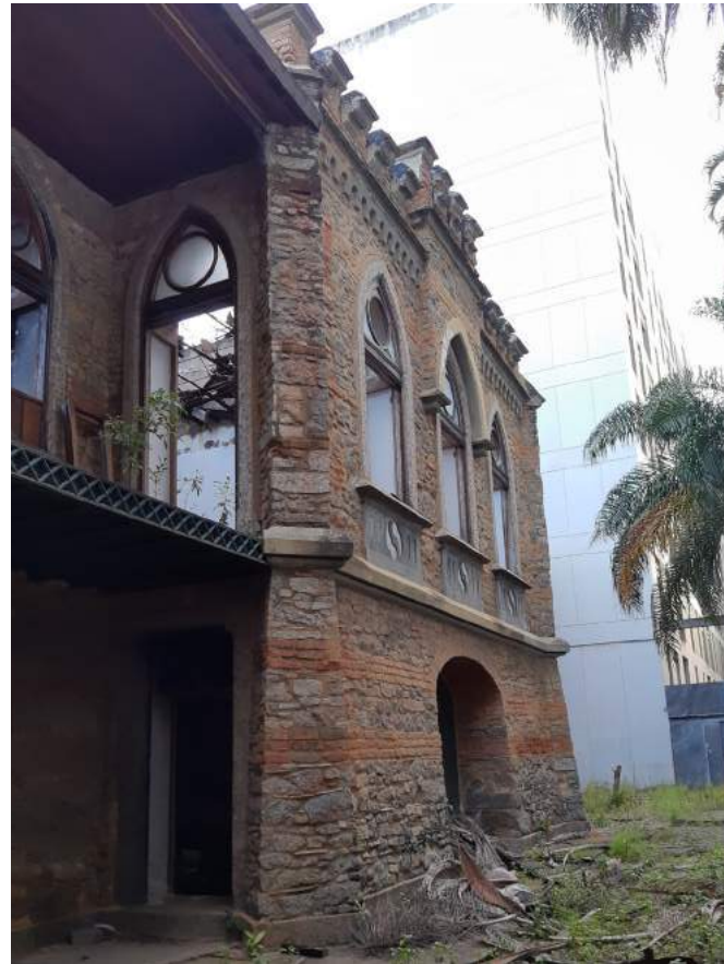
Vista 02 inferior - Vegetação em sua base e manchas negras na cimalha intermediária. Pode-se observar a ausência de forro e cobertura no pavimento superior.
