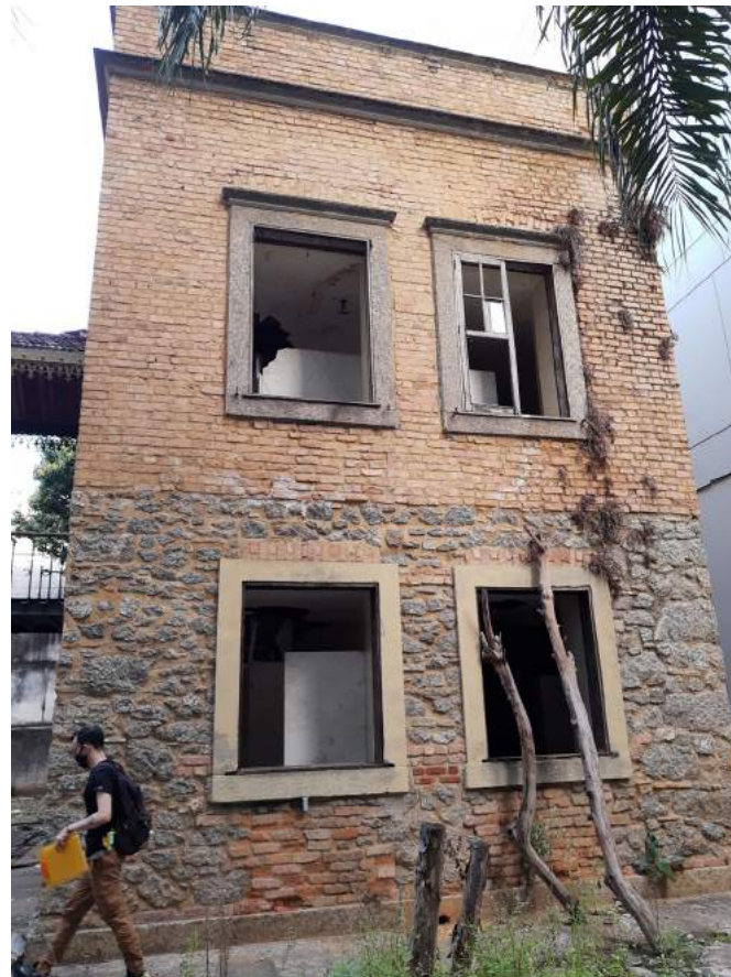
Vista 01 inferior - Vãos com esquadrias faltantes, somente um com uma folha de abrir, e vegetação pontual no trecho superior direito e com presença de mancha de umidade, o que indica provável infiltração.
