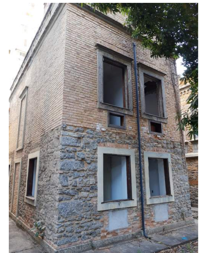
Vista 04 - Presença de vegetação e vãos com preenchimento inadequado e cercaduras em argamassa com tom diferenciado. Janelas com esquadrias faltantes; Vãos para ar condicionado, livres no trecho superior e com preenchimento inadequado no inferior. Presença de descida de água pluvial em pvc inadequada.
