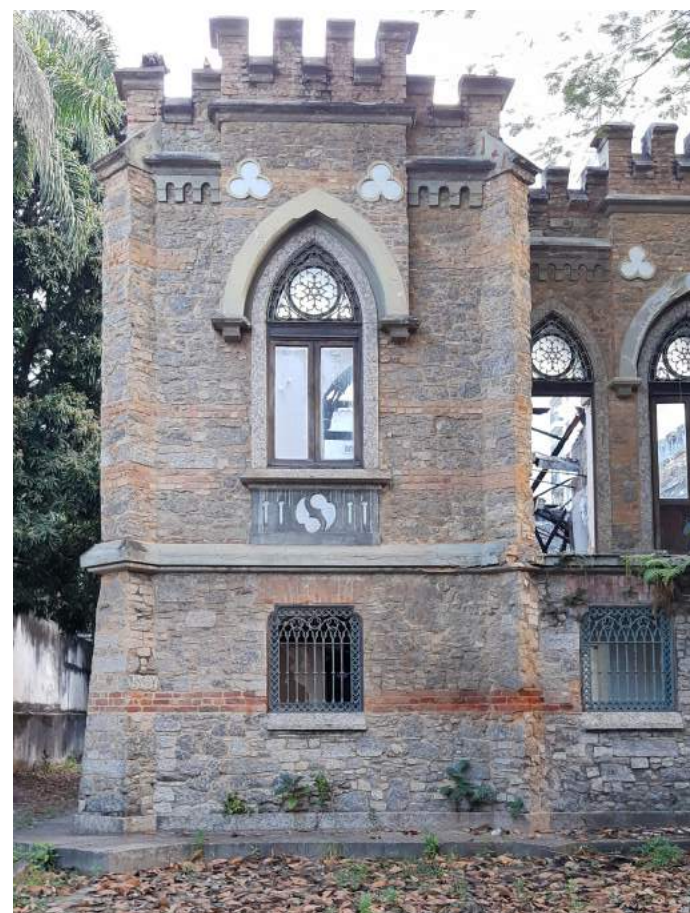
Vista 02 - Lateral contendo vegetação em sua base, parte faltante a direita do friso intermediário e manchas negras nas cimalkhas superiores.
