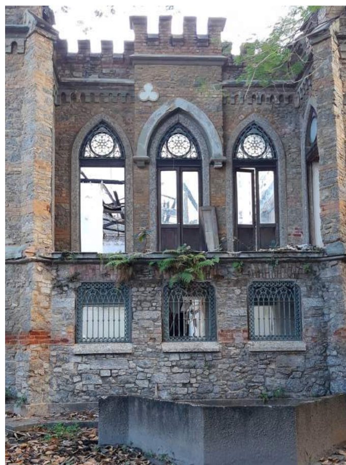
Vista 03 - Trecho central com vegetação acima das janelas, ausência do guarda corpo em ferro, arcada central com superfície degradada, ornato em trevo ausente, cimalkhas com mancha negra e porta esquerda ausente de folhas de abrir. Observa-se a presença de gradis nos vãos inferiores e bandeiras das portas
