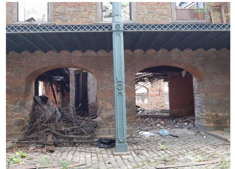
Vista 03 inferior - Vão esquerdo inacessível e vegetação na varanda acima. Observa-se o pilar em ferro fundido com ornamentação em relevo e estrutura do piso da varanda em laje abobadilha.
