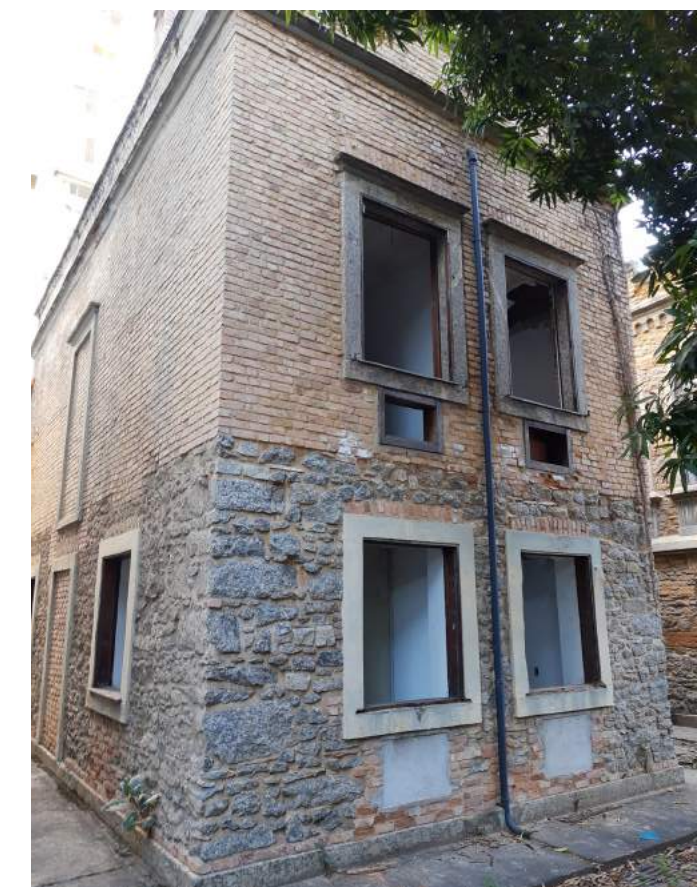
Vista 04 - Presença de vegetação e vãos com preenchimento inadequado e cercaduras em argamassa com tom diferenciado. Janelas com esquadrias faltantes; Vãos para ar condicionado, livres no trecho superior e com preenchimento inadequado no inferior. Presença de descida de água pluvial em pvc inadequada.
