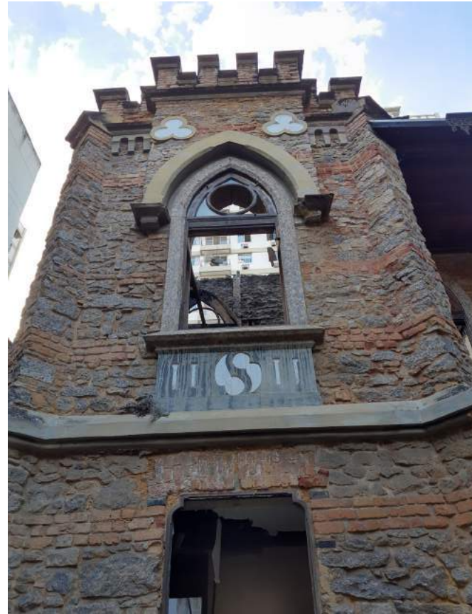
Vista 02 - Vão superior com vidro na bandeira, gradil e folhas de abrir faltantes. contendo friso com vegetação e manchas negras.
