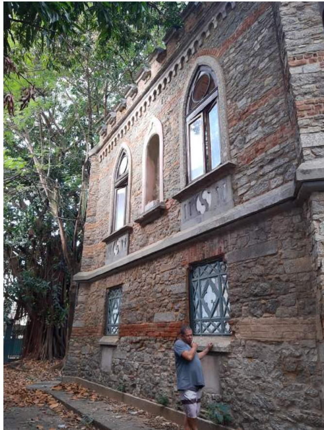
Vista 01 - Presença de esquadrias em ferro no trecho inferior, com preenchimento inadequado abaixo destes e presença de vegetação em sua base. Ausência de gradis e vidro nas bandeiras das esquadrias superiores, mas com presença das folhas de abrir integras.
