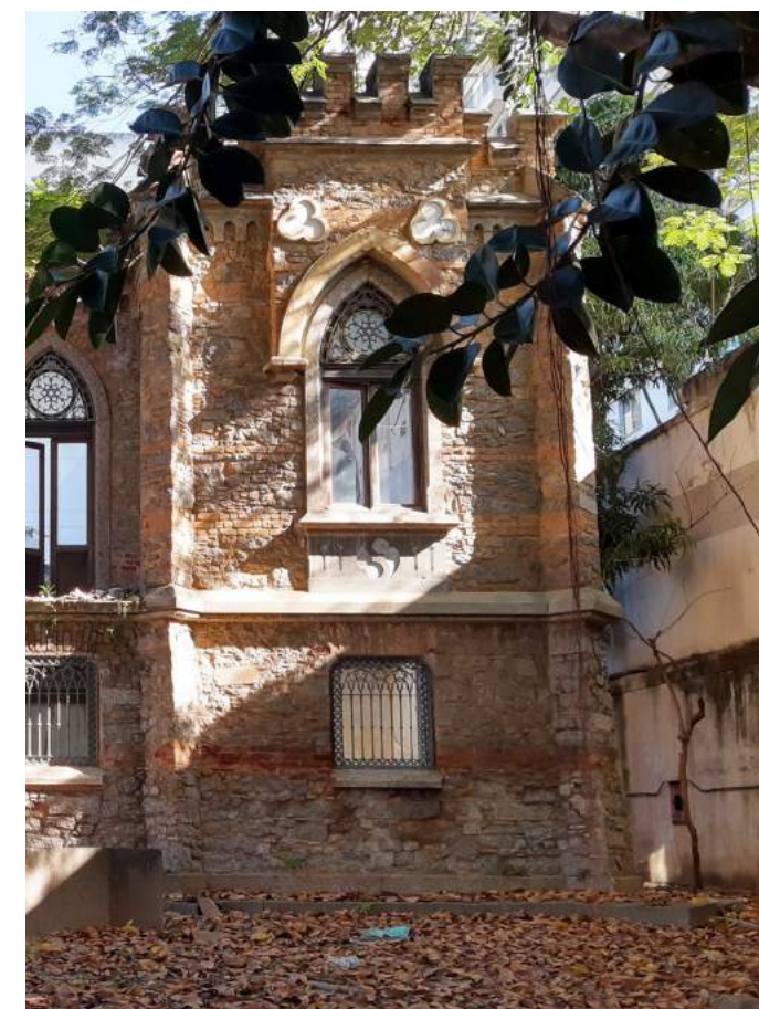
Vista 04 - Lateral com vegetação em sua base, arcada superior deteriorado e manchas negras no embasamento a direita e cimalthas superiores.
