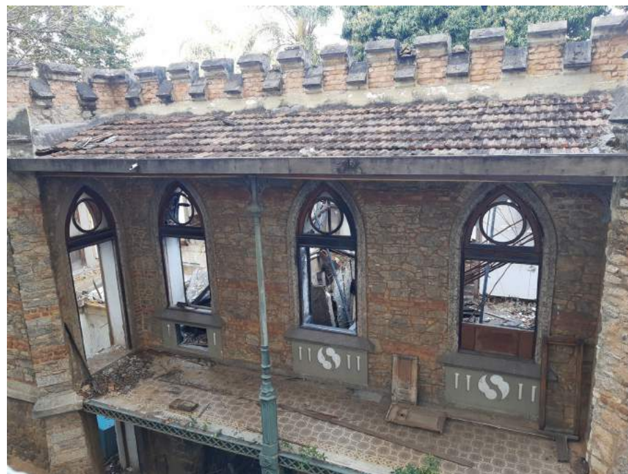
Vista 03 superior - Varanda com guarda-corpo e lambrequins em ferro fundido faltantes. Piso hidráulico preservado e presença de vegetação nas margens externas. Lacuna abaixo da janela a esquerda e esquadrias com gradis, folhas de abrir e vidros nas bandeiras faltantes. Cimalhas, ameias e canaleta de água pluvial com manchas negras.
