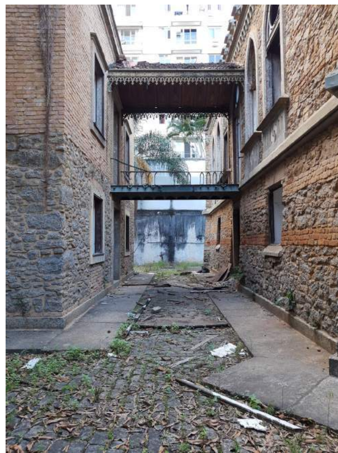
Vista 03 - Vãos com esquadrias e gradis faltantes, passarela com escada em ferro faltante, lambrequins oxidados e guarda corpo danificado.
