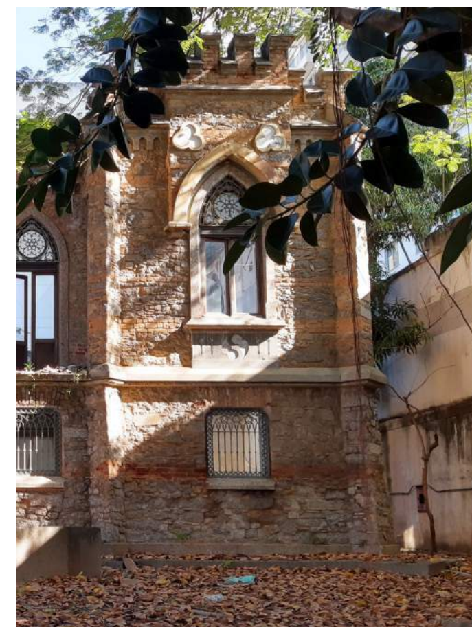
Vista 04 - Lateral com vegetação em sua base, arcada superior deteriorado e manchas negras no embasamento a direita e cimalkhas superiores.
