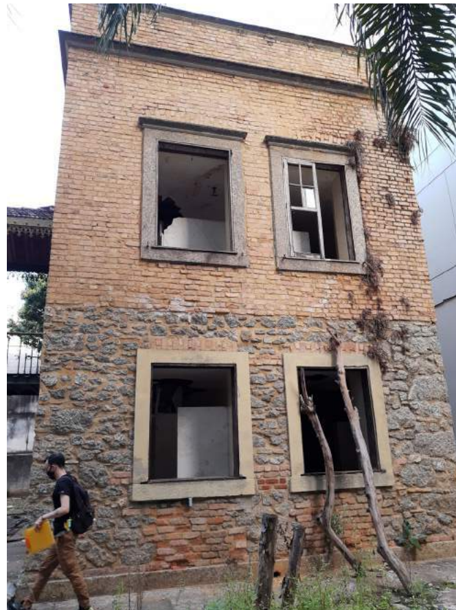
Vista 01 inferior - Vãos com esquadrias faltantes, somente um com uma folha de abrir, e vegetação pontual no trecho superior direito e com presença de mancha de umidade, o que indica provável infiltração.
