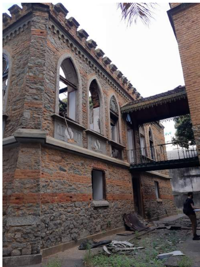
Vista 02 - Idem vista 02. Pode-se observar a presença de gradil de um dos vãos superiores. O vão de acesso a passarela não possui esquadria, assim como os demais vãos superiores.
