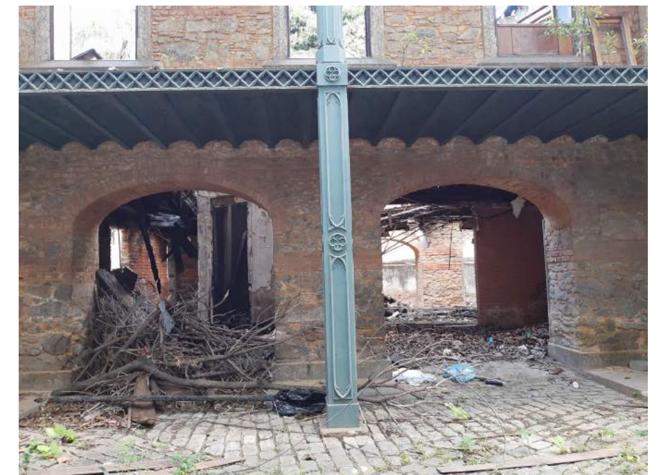
Vista 03 inferior - Vão esquerdo inacessível e vegetação na varanda acima. Observa-se o pilar em ferro fundido com ornamentação em relevo e estrutura do piso da varanda em laje abobadilha.
