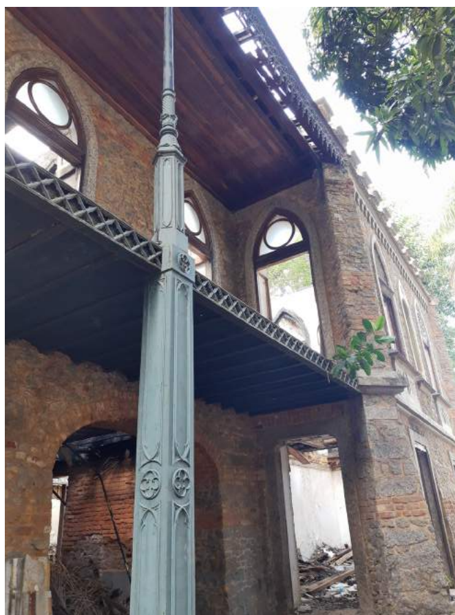
Vista 04 - Idem vista 03, contendo também vãos com esquadrias faltantes e vegetação na margem da varanda.
