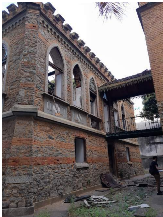
Vista 02 - Idem vista 02. Pode-se observar a presença de gradil de um dos vãos superiores. O vão de acesso a passarela não possui esquadria, assim como os demais vãos superiores.
