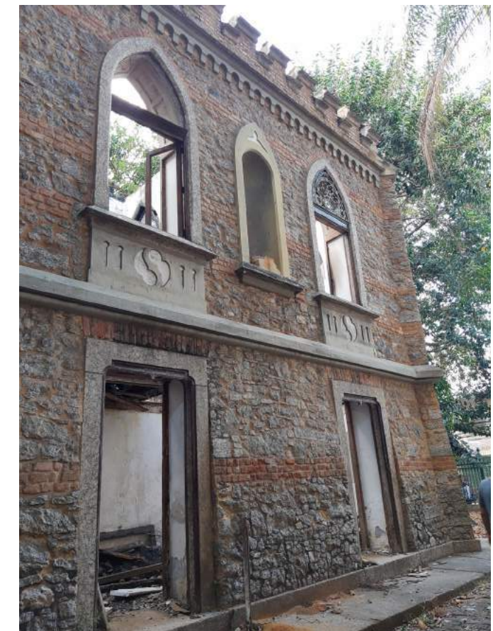
Vista 05 - Vãos inferiores com esquadrias faltantes, vão superior esquerdo somente com suporte da esquadria e vão direito com vidro da bandeira faltante.
