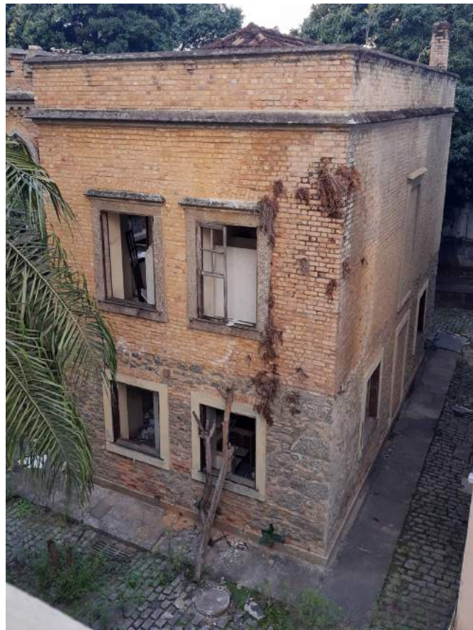
Vista 01 superior - Idem vista inferior, evidenciando também cimalthas com manchas negra. No canto direito da platibanda nota-se a presença de uma chaminé.
