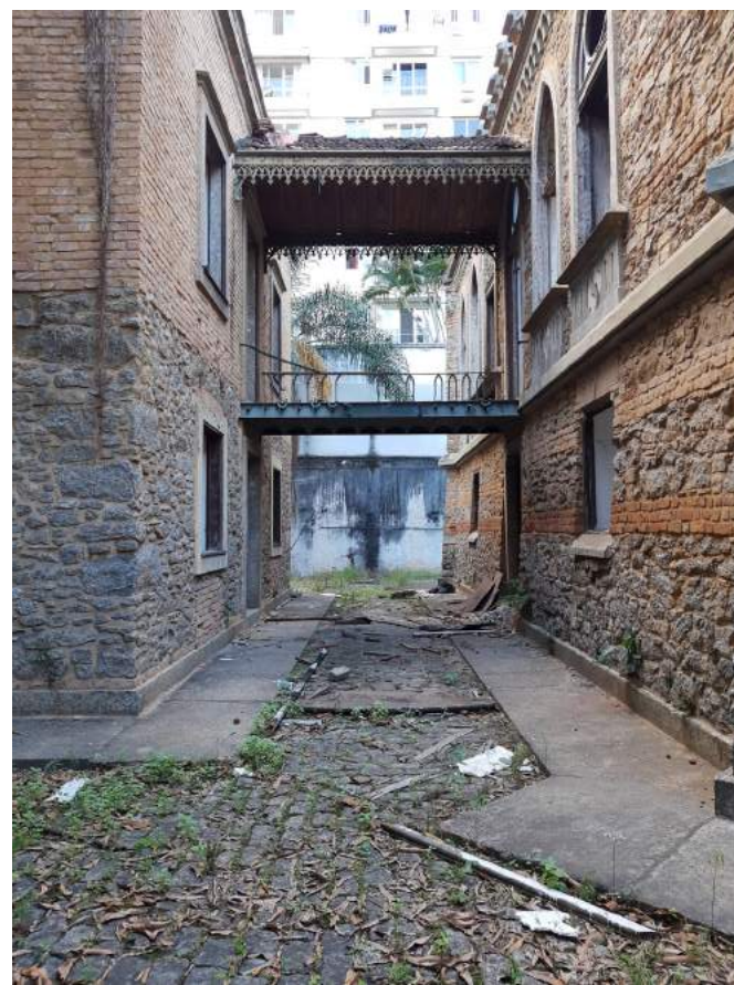
Vista 03 - Vãos com esquadrias e gradis faltantes, passarela com escada em ferro faltante, lambrequins oxidados e guarda corpo danificado.
