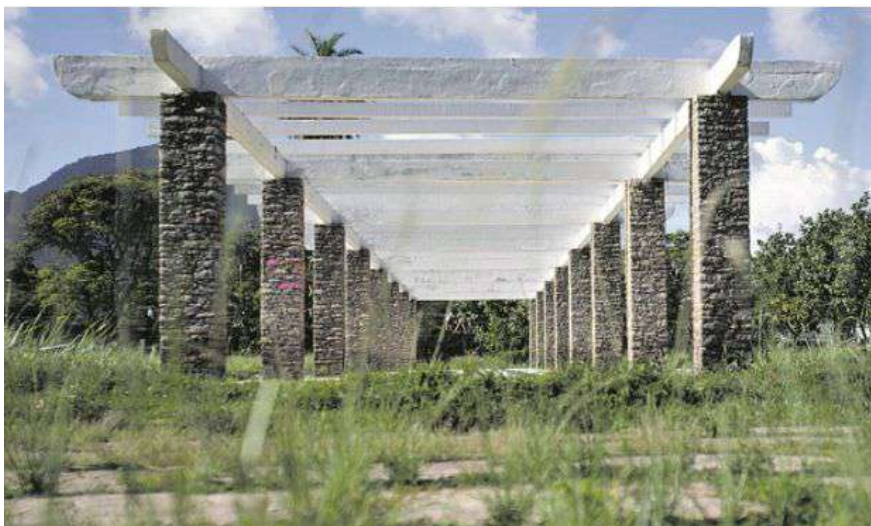
Figura 22: Pergolado em área visivelmente carente de manutenção
