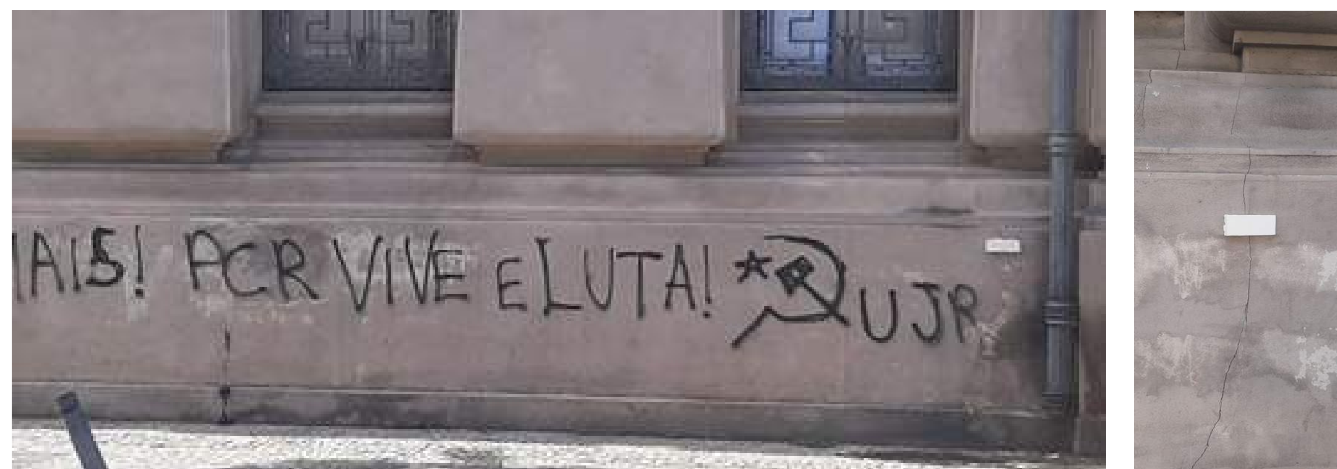
Figura 23 - Superior esquerda, detalhes da situação atual da fachada. Vegetação existente na fachada da esquina das ruas da Relação e dos Inválidos. Fonte: Acervo pessoal
