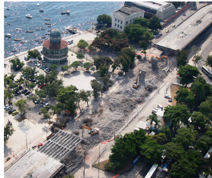
Foto da demolição onde podemos ver as vigas de aço cobertas de concreto
