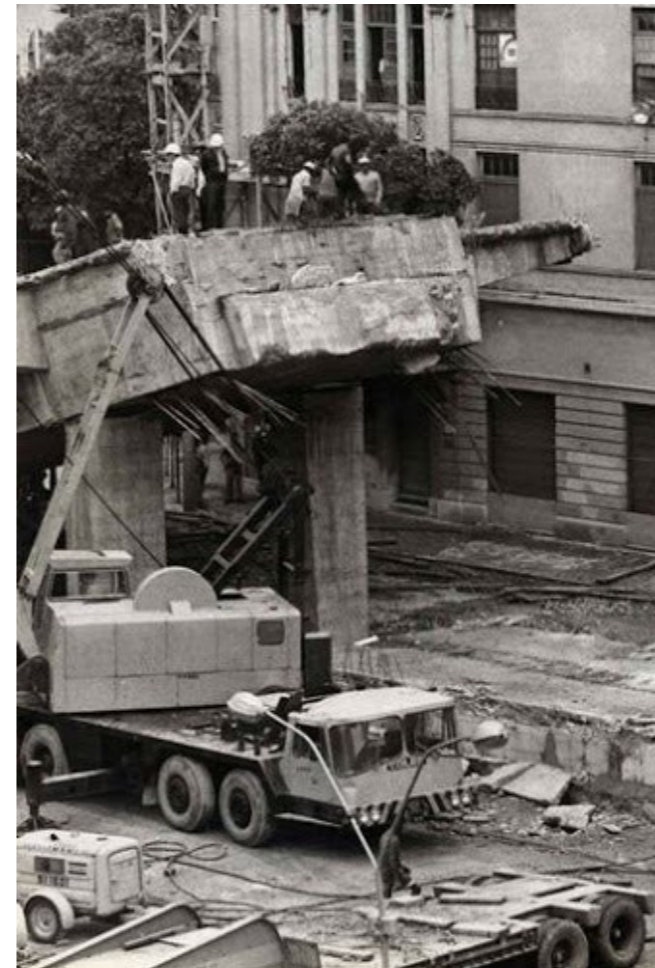
Foto da queda do viaduto onde podemos observar a seção da estrutura.
