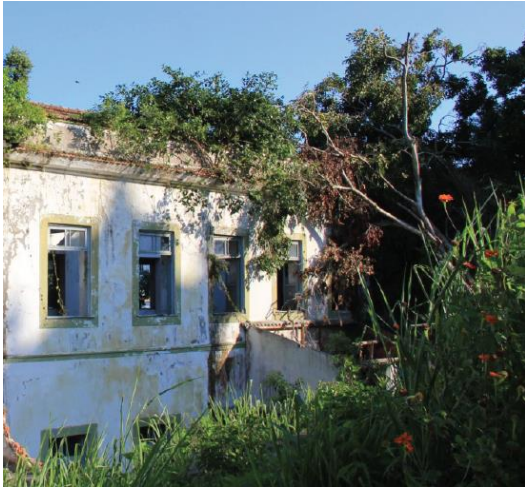
Figura 7: Árvores de grande porte que caíram sobre a edificação do Bloco 1, durante as tempestades do início do ano de 2019, gerando grandes danos à cobertura da edificação. Foto: Autoral; Ano:2019
