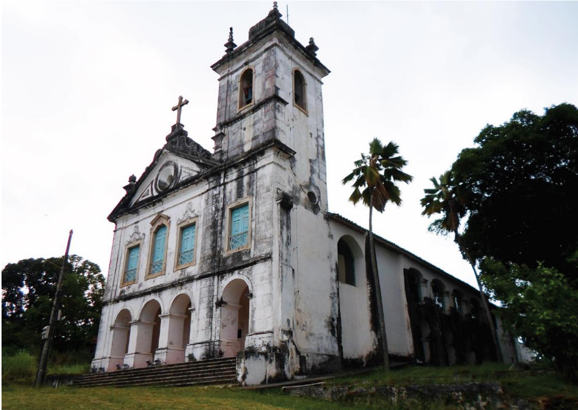
Figura 18: Igreja do Bom Jesus atualmente, necessitando de um novo restauro das fachadas. Foto: Jéssica Martins; Ano: 2019
