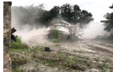
demolição das antigas edificações fabris para futuro empreendimento na área (fonte: realengoempauta.com.br)
