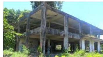
estruturas em estado de abandono por décadas (fonte: realengoempauta.com.br )
