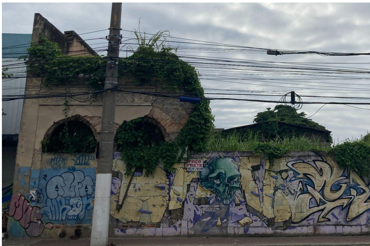
Figura 15 - Fachada em ruínas do terreno proposto.
