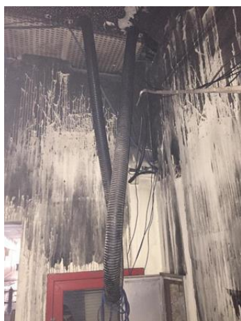
Figura (49) - Aspecto após o incêndio. Fonte (a autora, 2021).
