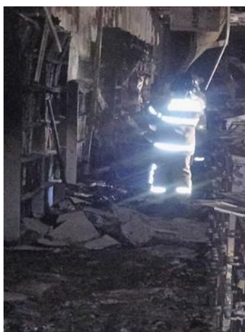
Figura (50) - Aspecto após o incêndio. Fonte (a autora, 2021).
