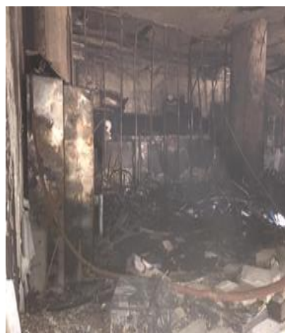
Figura (51) - Aspecto após o incêndio. Fonte (a autora, 2021).
