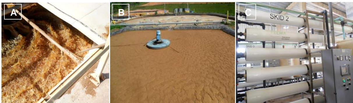
Figura 2 – Etapas do tratamento de lixiviado. A. Arraste de amônia (tratamento químico). B. Lagoa de lodo ativado. C. Equipamento de nanofiltração (tratamento físico).
