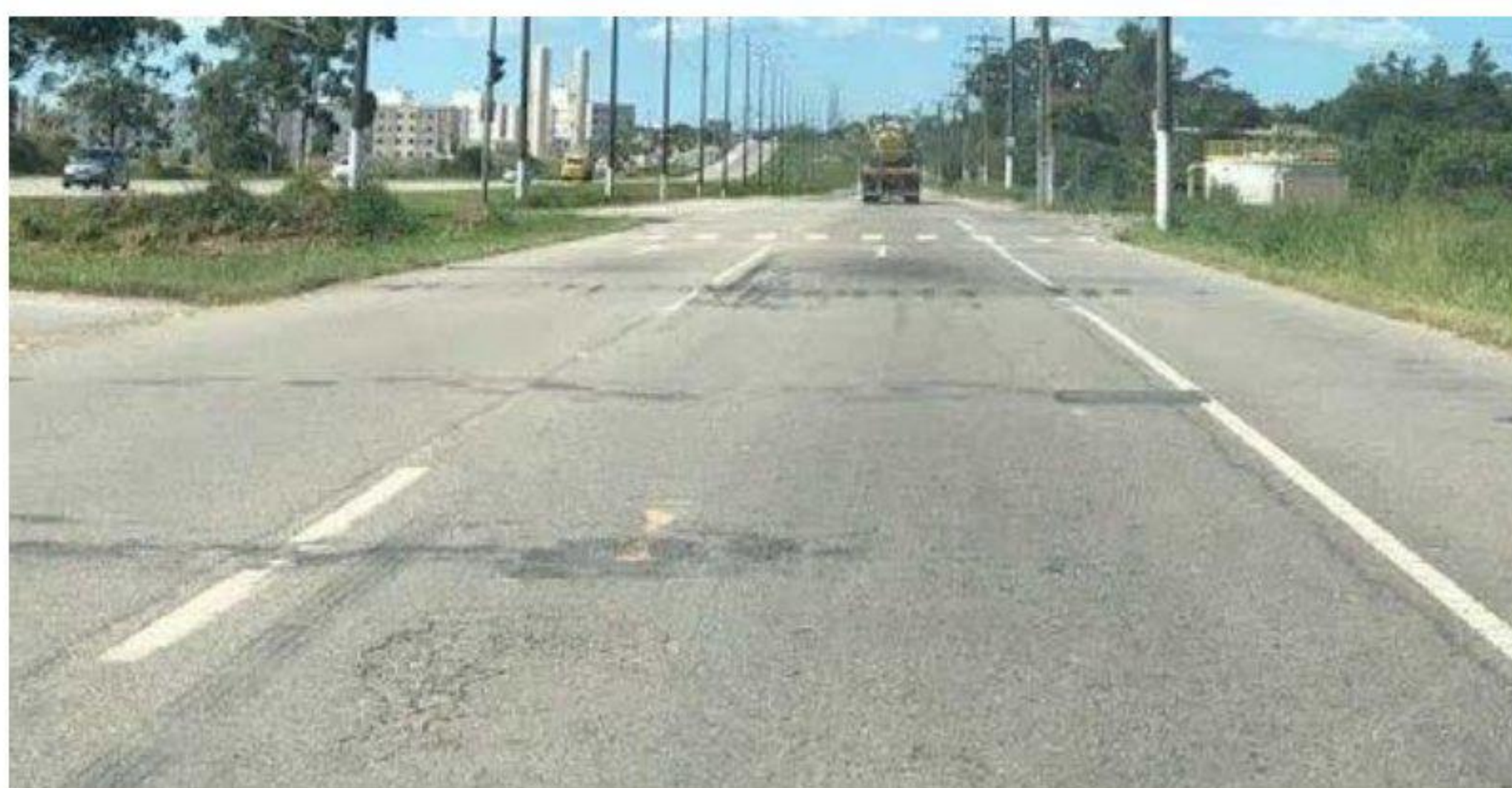
Fotografia 12 - Pista com irregularidades no pavimento. Fonte: Própria autora
