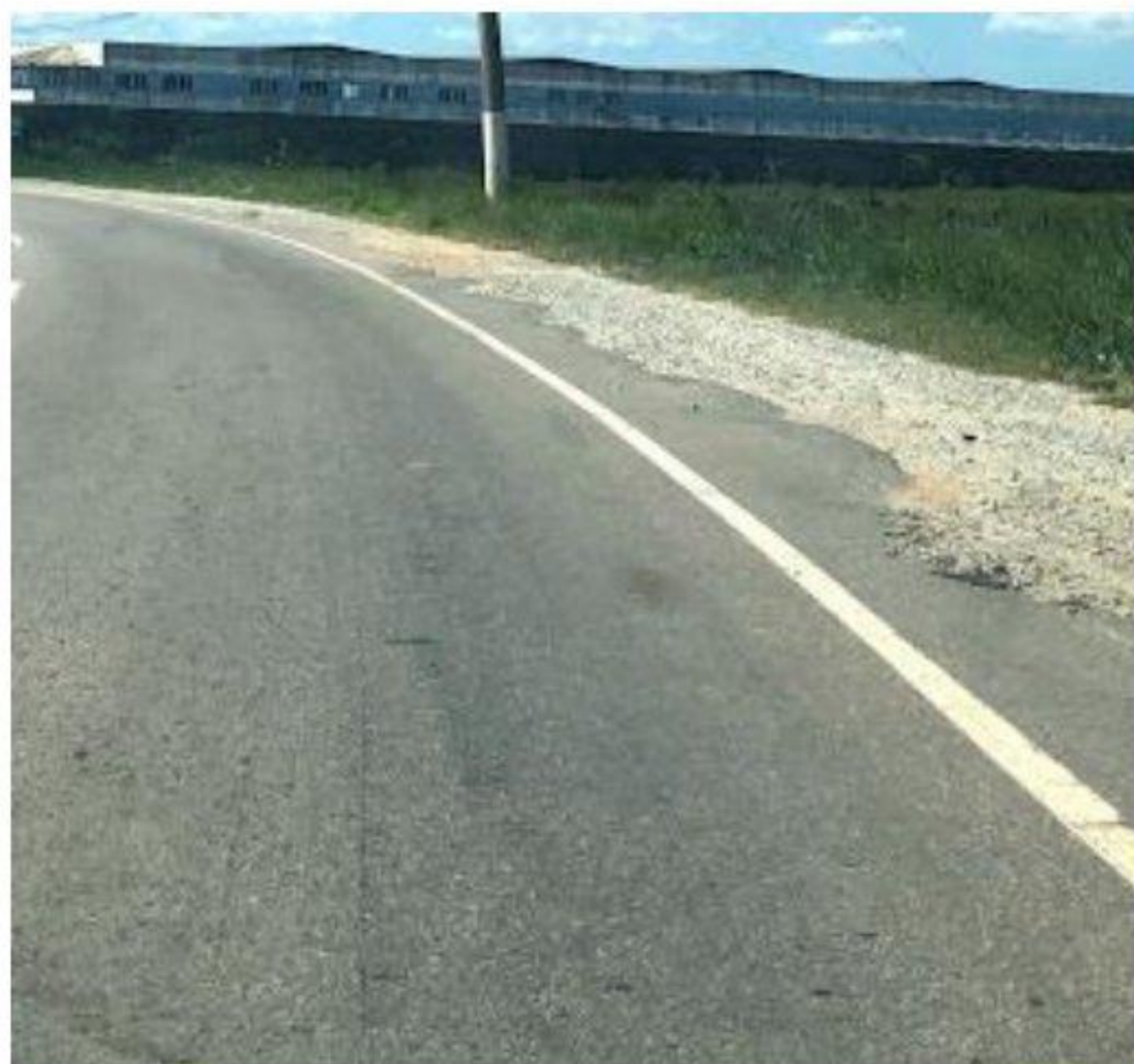
Fotografia 1 – Erosão no acostamento. Fonte: própria autora
