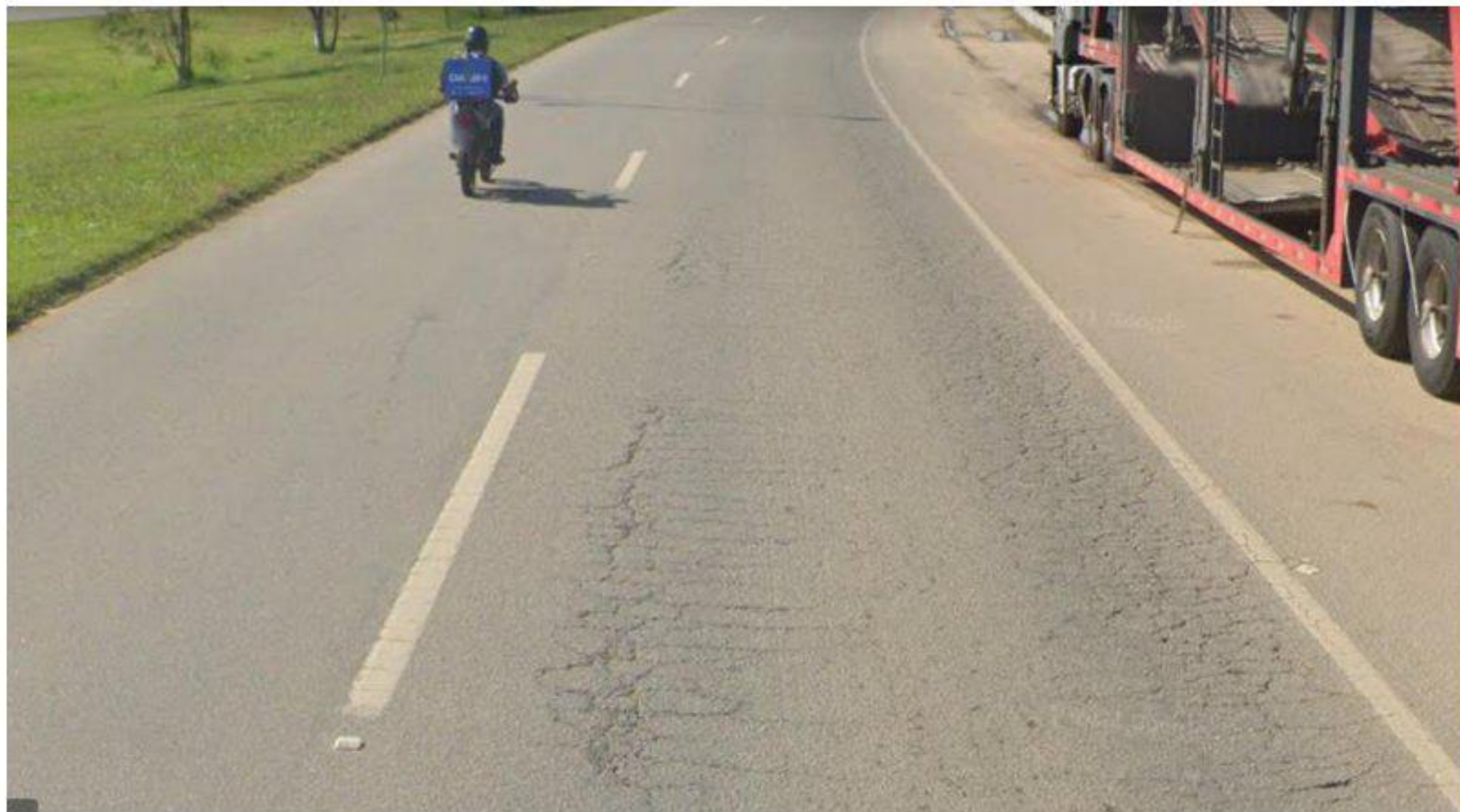
Fotografia 15 - Trincas interligadas no revestimento. Fonte: Própria autora
