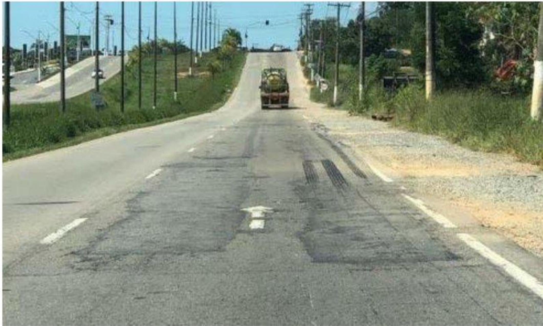
Fotografia 13 - Revestimento com remendos, trincas e erosão nas bordas. Fonte: Própria autora
