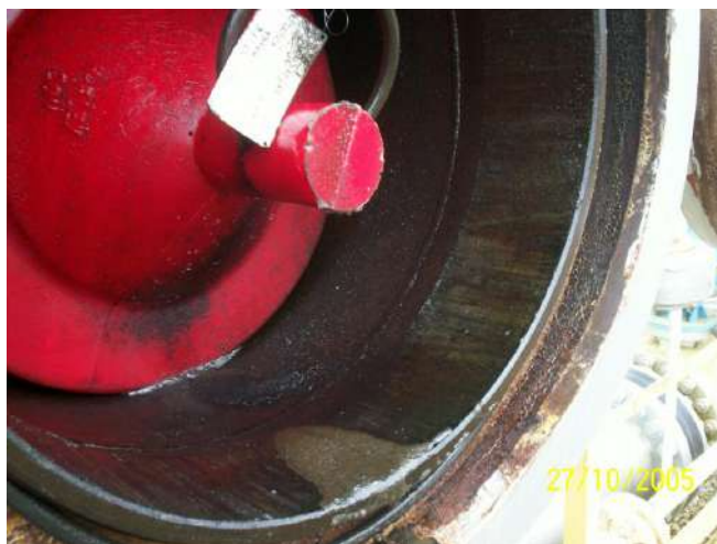
Figura 9 – Resíduo no canhão recebedor de PIG (Relatório de Integridade de Dutos - Transpetro, 2011)
