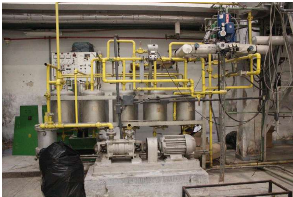
Figura 15- Vasos de armazenagem de produto.
