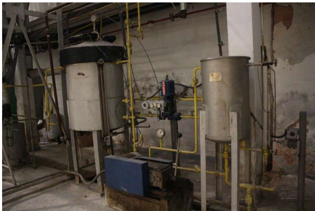
Figura 16 – Caldeira e vaso de alimentação.
