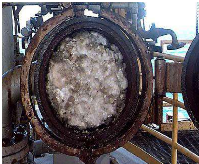
Figura II.4 – Hidrato no interior da linha [21]
