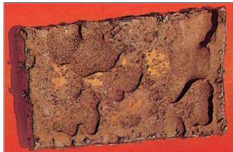
Figura II.2 – Corrosão em placas em chapa de aço-carbono encostado em tanque (GENTIL, 2007).
