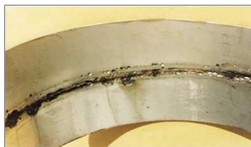
Figura II.12 - Tubulação de aço inox que sofreu corrosão em torno do cordão de solda (GENTIL, 2007).
