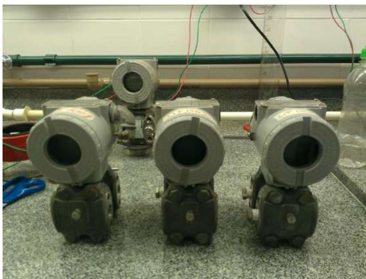
Figura 3.10: Medidores/Transmissores de nível
