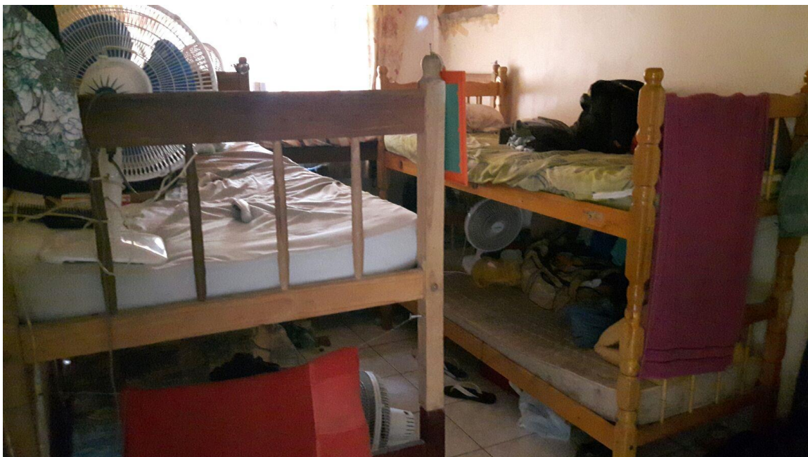
Figura 5 – Dormitórios com paredes mofadas
