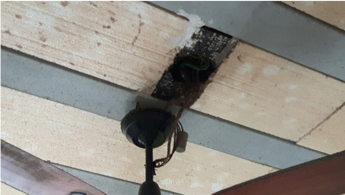
Figura 6 – Fios desencapados expostos
