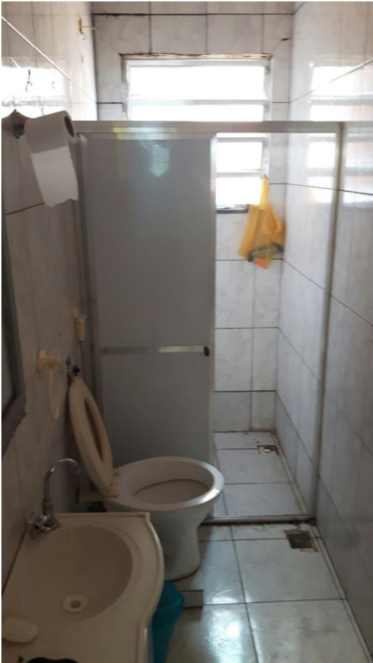
Figura 7 – Banheiro sem descarga e chuveiro
