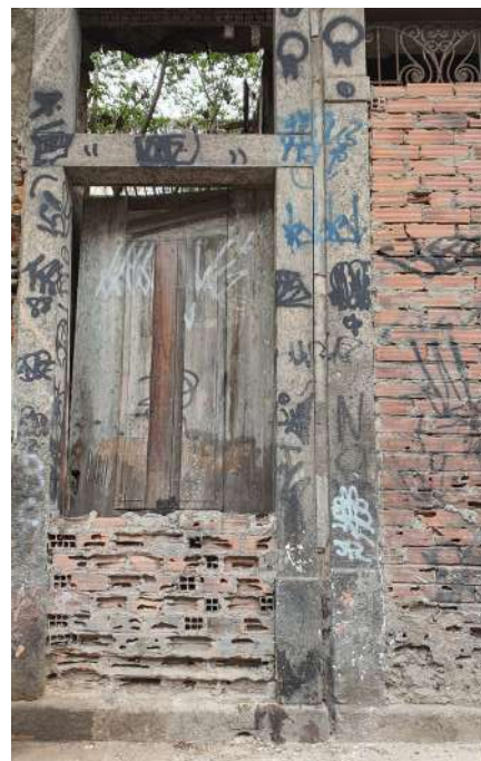
Figura (c) Detalhe da fachada de uma das edificações existentes na área de intervenção. Os vãos foram brutalmente fechados através de paredes de alvenaria, que já apresentam-se desgastadas pelo tempo. A edificação está em ruínas, restando apenas trechos desta fachada.
